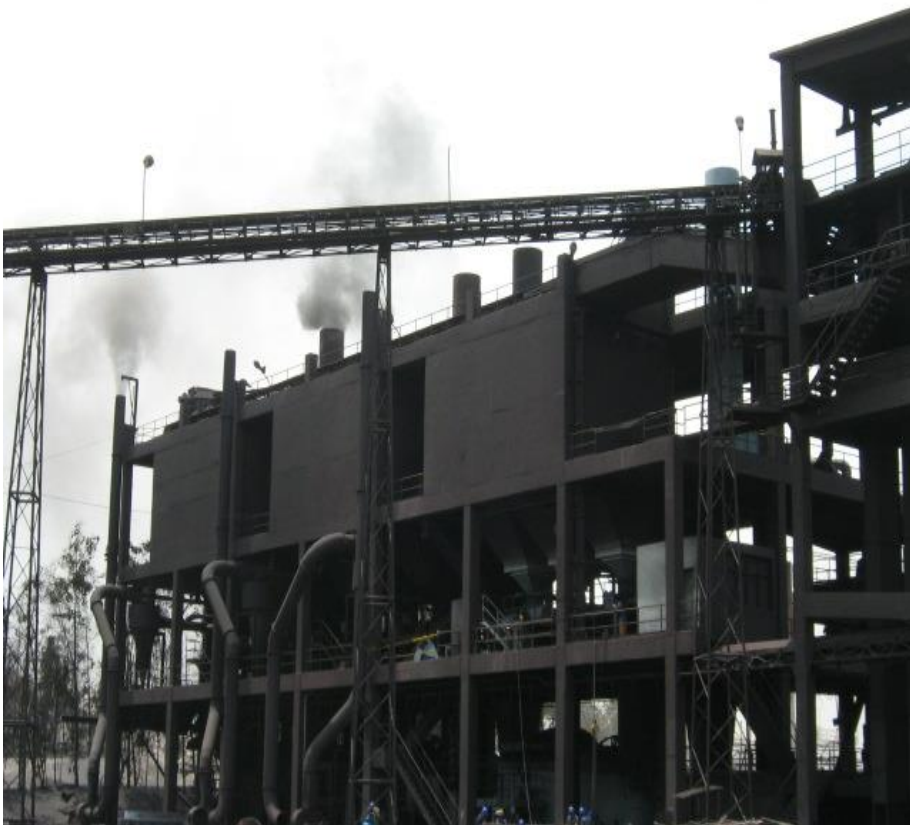
Faja transportadora y chimenea del HRD n° 1 y 2 emitiendo finos
