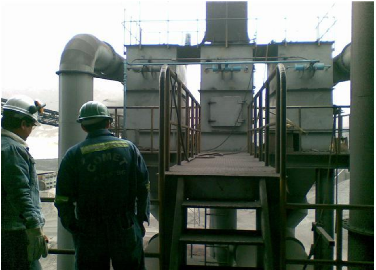
Plataforma de mantenimiento a los filtros de manga
