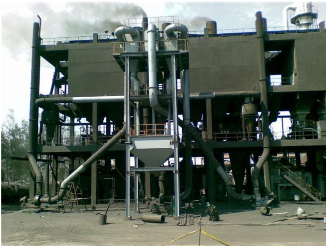
Hornos n° 1 y 2 trabajando sin los filtros salida directa
