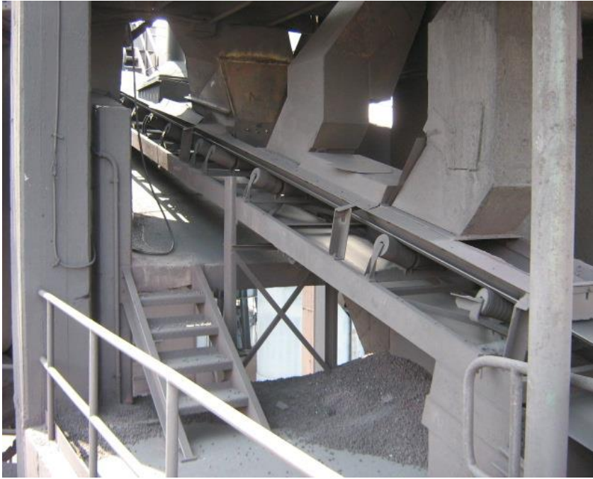
Chute de descarga a la faja de alimentación a las tolvas de cada uno de los hornos mediante un carro tripper.
