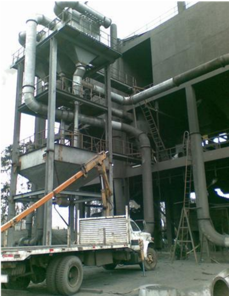
Sistema de filtro de mangas para los tres hornos terminado de instalarse
