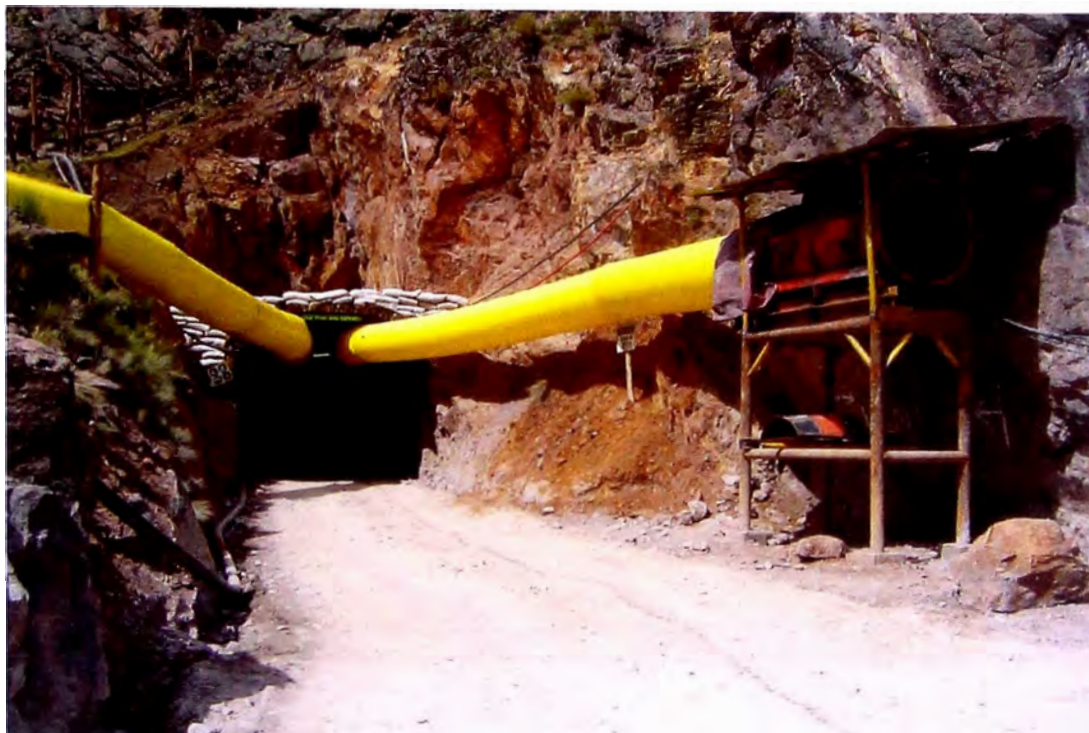
Foto N° 7: Ventilador de 40,000cfm, Insuflando Aire Limpio con Manga de Ventilación de 36 pulgadas de Diámetro. Bocamina Corina 800 Nv. 800 - Rayo Corina.
