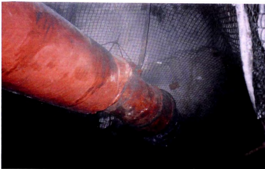
Foto N° 5: Ventilador de 30, 000 cfm Insuflando Aire Limpio con Manga de Ventilación de 36 pulgadas de Diámetro. Crucero 740 Rayo Siberia – Nv. 800.
