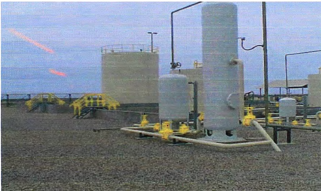
Foto N°14 Disposición de Separador y "Vol-U-Meter" en Batería 608
