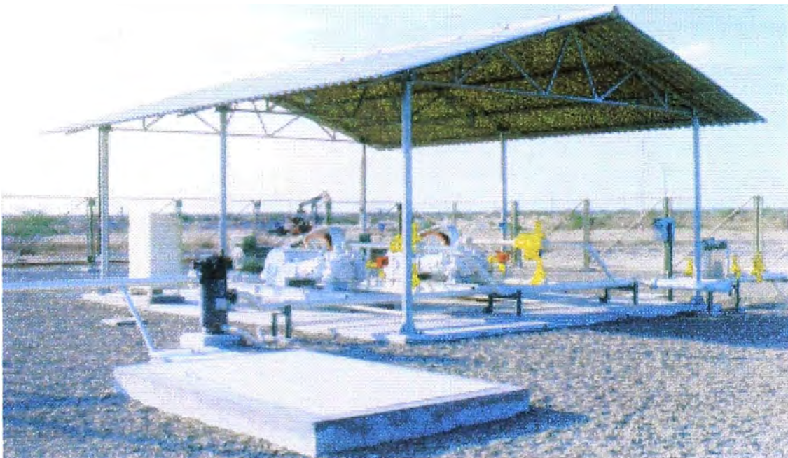
Foto N°16 Vista de filtro en línea de succión de Bombas
