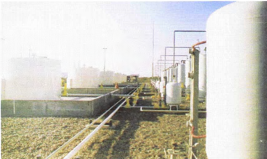
Foto N°6 Vista de Disposición de Tanques auxiliares y "Vol-U-Meters" en Batería 951
