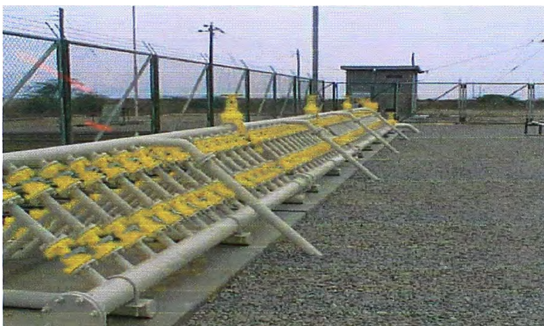
Foto N°12 Vista de Múltiples "Manifolds" instalados en Batería 608
