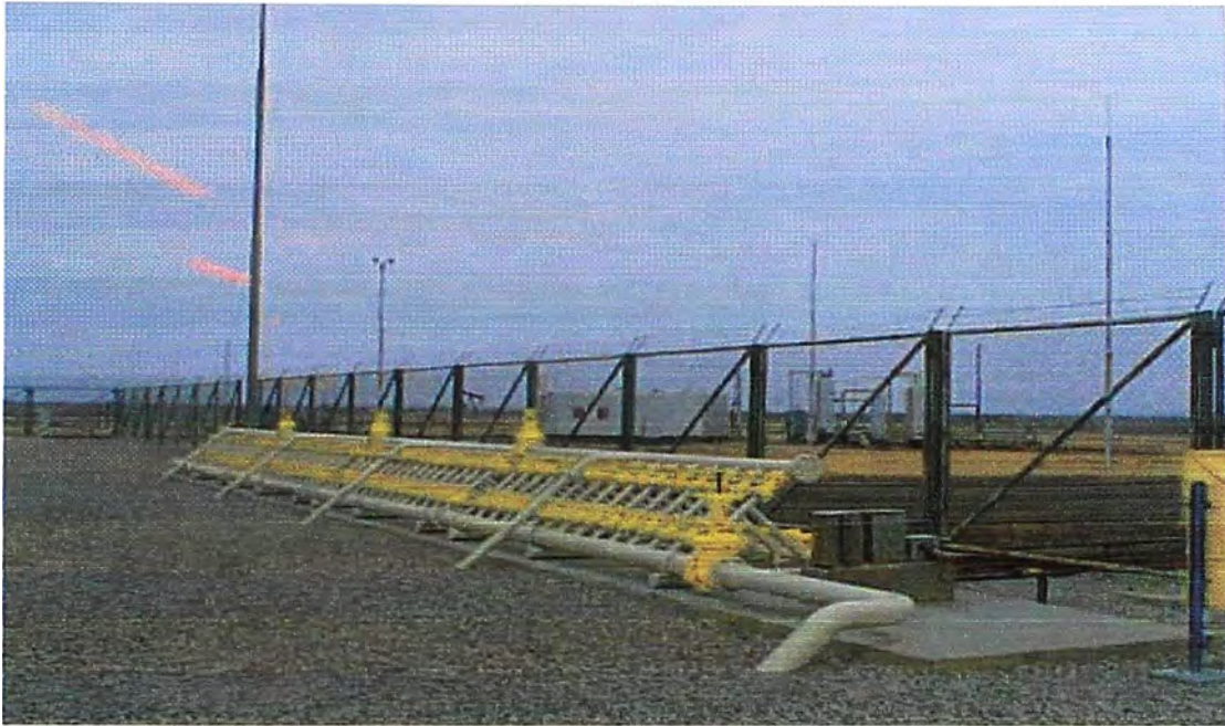
Foto N°13 Vista de "Manifold" y Bomba de inyección de química en Batería 608
