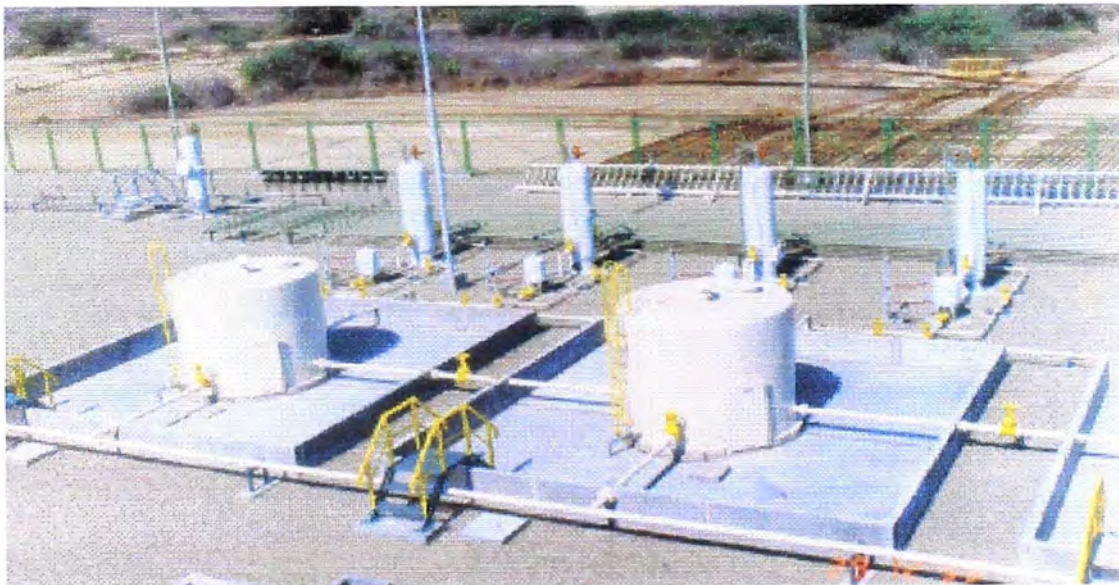
Foto N°18 Vista de Tanques auxiliares en Bateria 951
