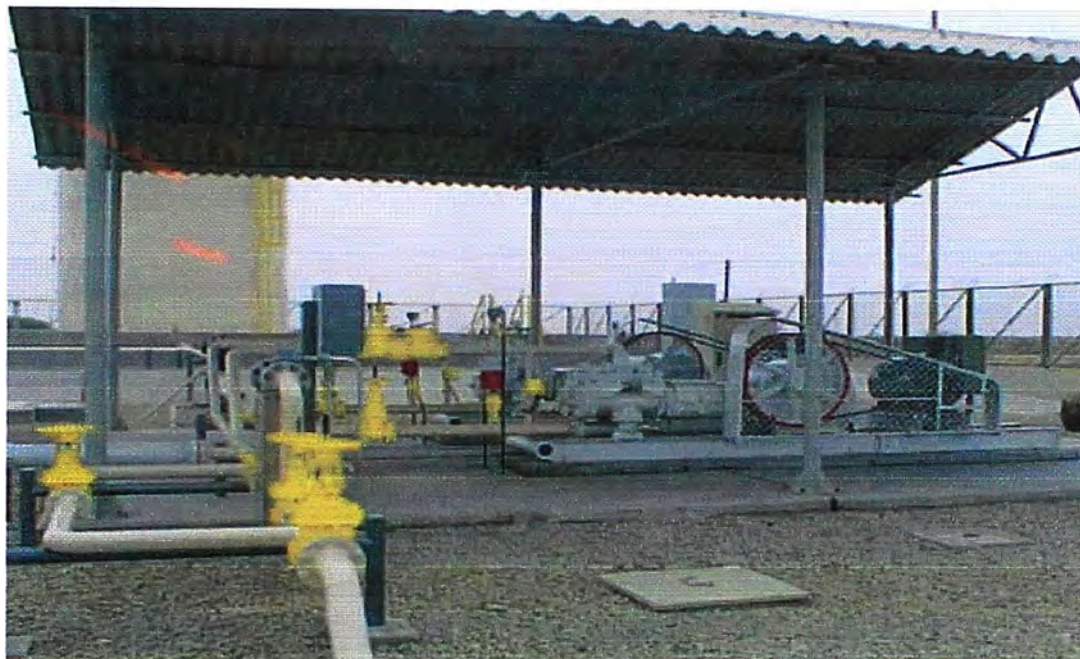
Foto N°11 Caseta de Bombas Batería 608
