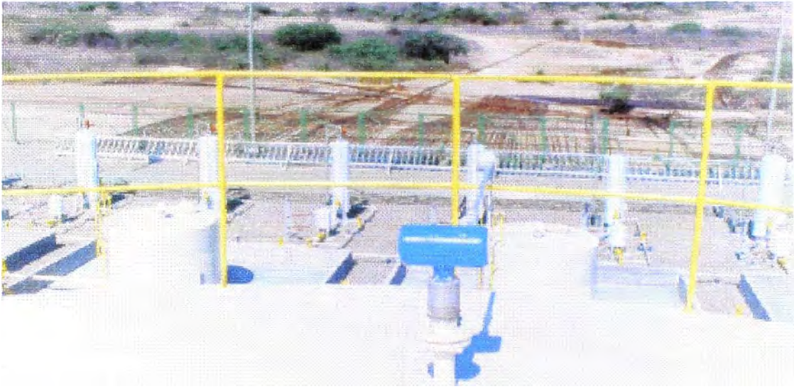
Foto N°17 Medidor de Nivel e interface "Krone" instalado en el Tanque Principal.
