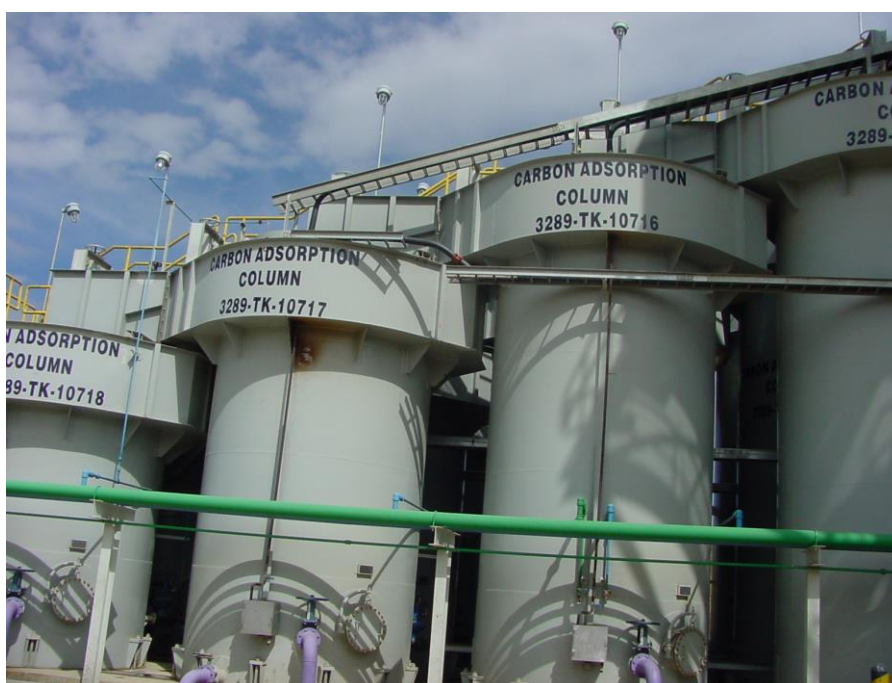
Fig. 1.15: Columnas de carbón del circuito de adsorción planta La Quinoa
