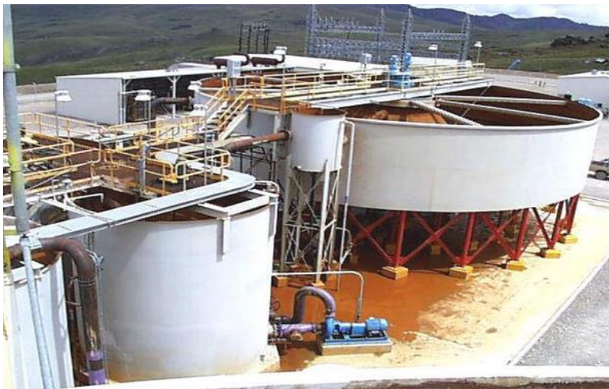
Fig. A: Vista de la planta de tratamiento EWTP - Pampa Larga
