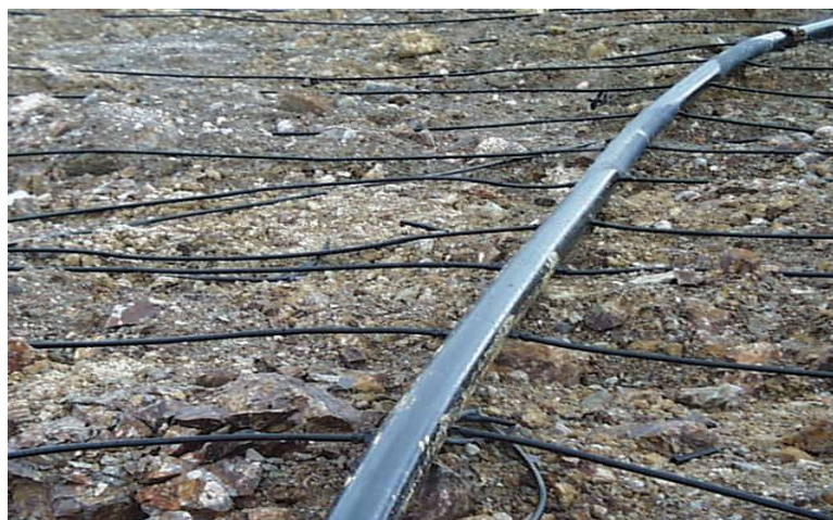
Fig. 1.9: Sistema de riego por goteo empleado en los pads de lixiviación
