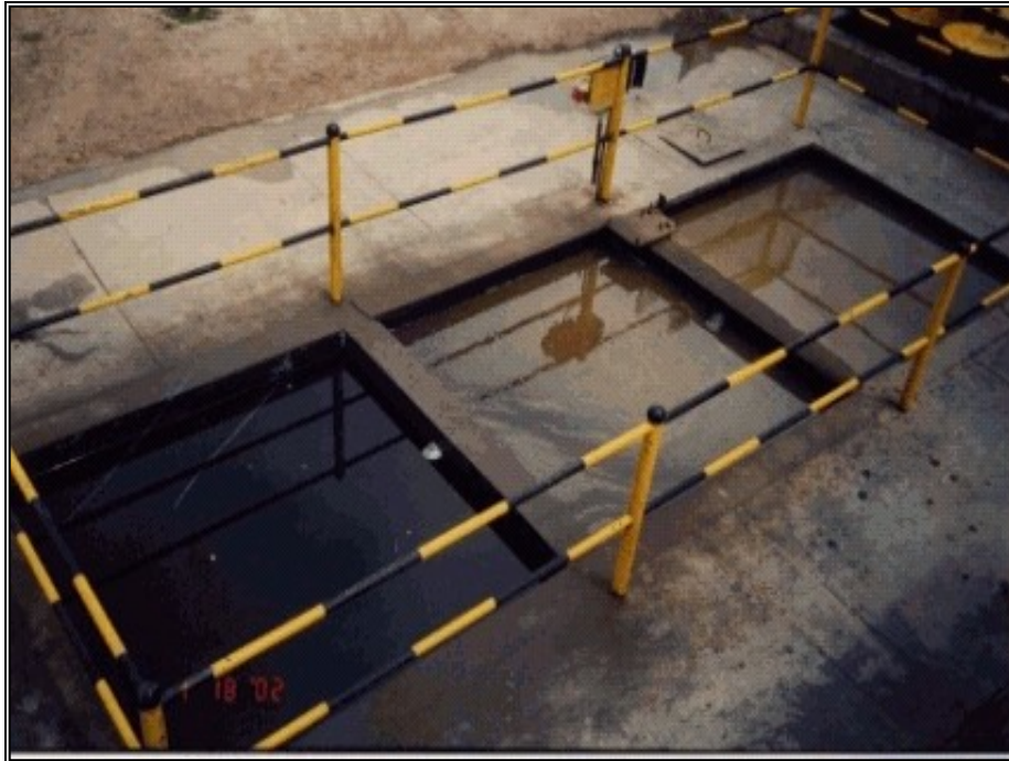
Foto B17 Trampas de grasas y aceites en el lavadero de vehículos
