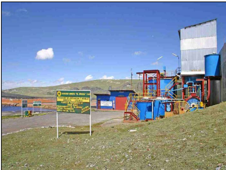
Foto B20 Planta de tratamiento de aguas ácidas
