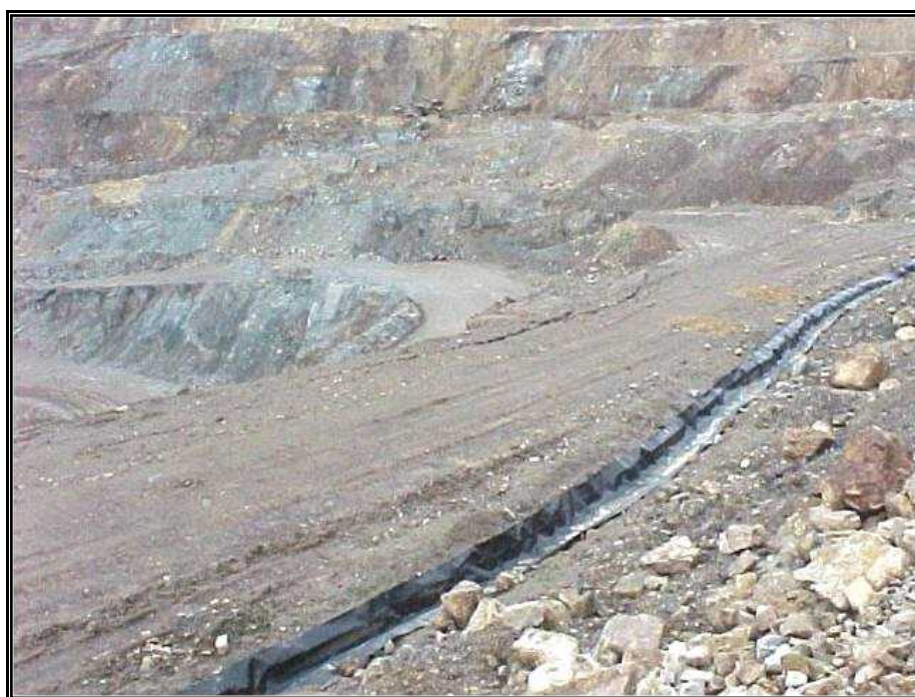
Foto B24 Canales de derivación de aguas de escorrentía alrededor del tajo abierto, impermeabilizadas
