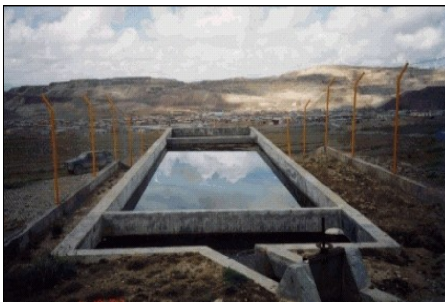
Foto B4 Sedimentador de la Planta de Tratamiento. Colquijirca
