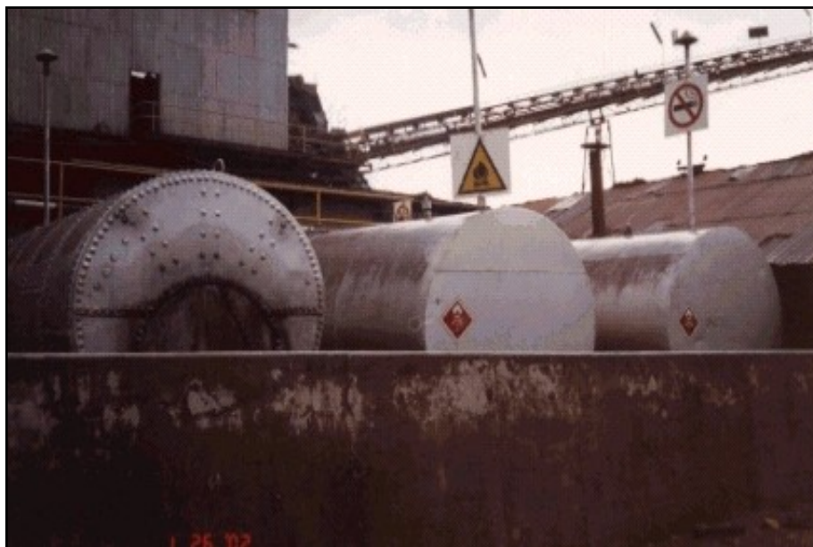
Foto B15 Tanques de combustibles con sus bermas antiderrames
