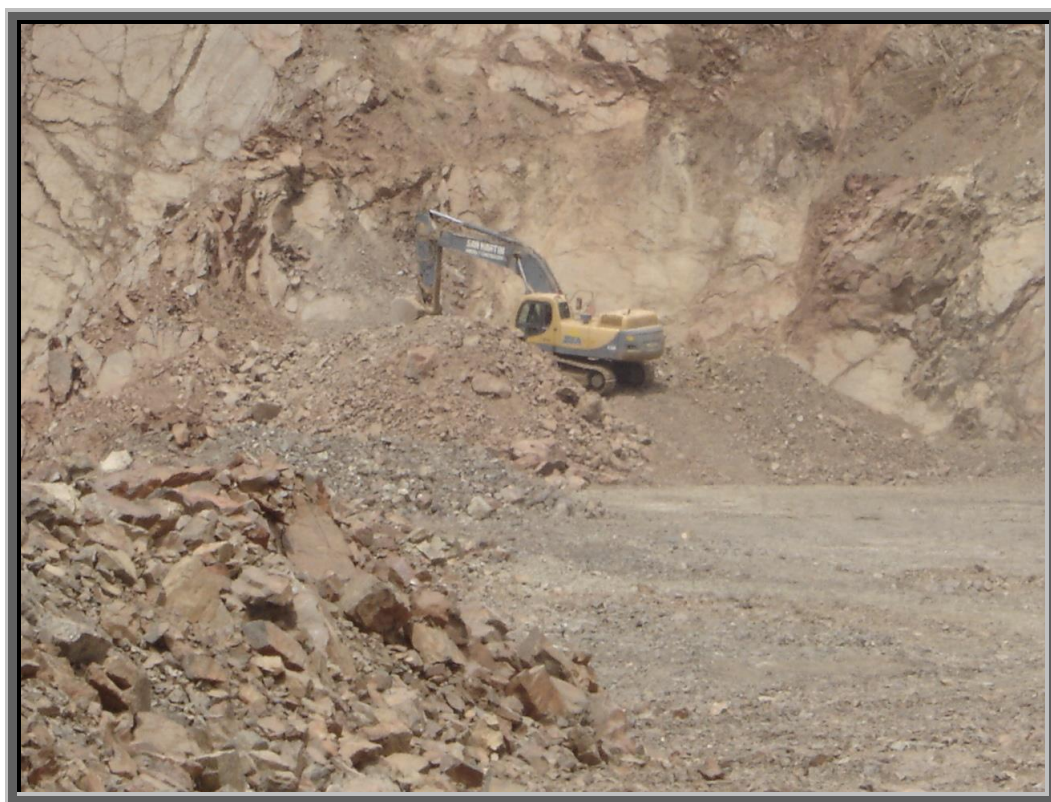
Excavadora Volvo de San Martín realizando desquinche del talud en el Nv. 725.
