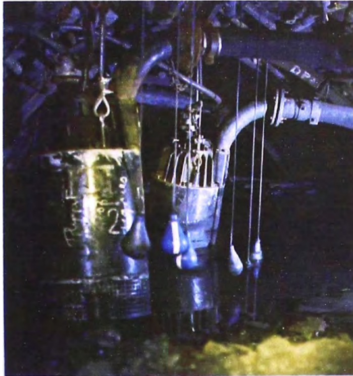
FIG No1-3 Bombas instaladas en una zona de acoplo, funcionan mediante sondas de nivel.
