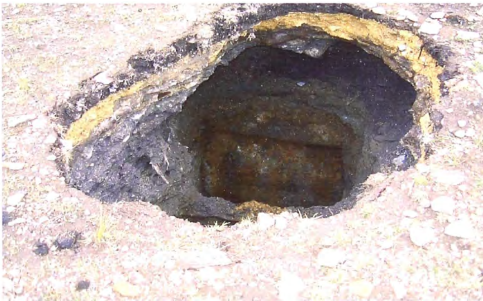
FIG No 5-2 Succión de carga en el Pique Almiranta (Se observa la estructura del Pique)
