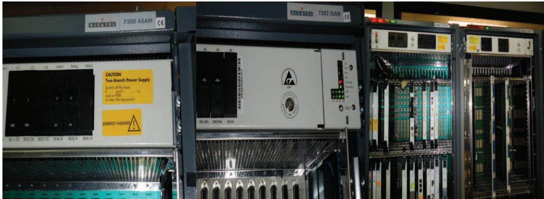
FIGURA 3.2 DSLAM ATM 7300 ASAM y ETHERNET 7302 ISAM DE ALCATEL (Fuente: Telefónica del Perú S.A.A.)
