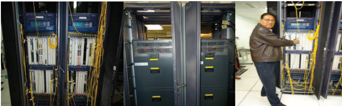
FIGURA 4.22 SWITCH CAPA L2/L3/L4 NE80E DE HUAWEI (Fuente: Telefónica del Perú S.A.A.)
