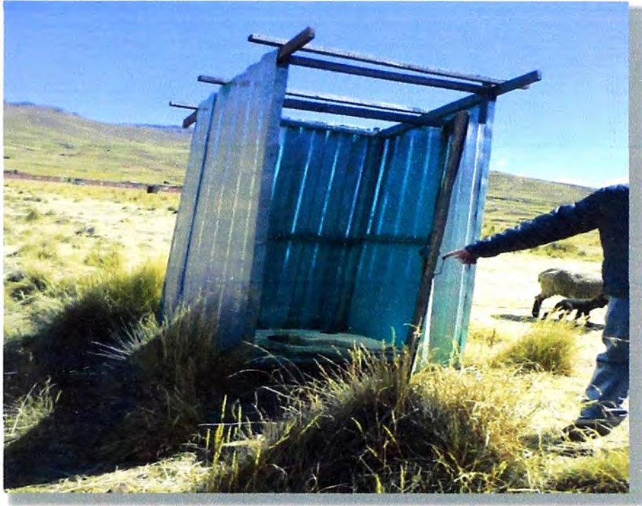
LA UNICA LETRINA QUE EXISTE EN LA LOCALIDAD Y SE ENCUENTRA EN CONDICIONES PAUPERRIMA
