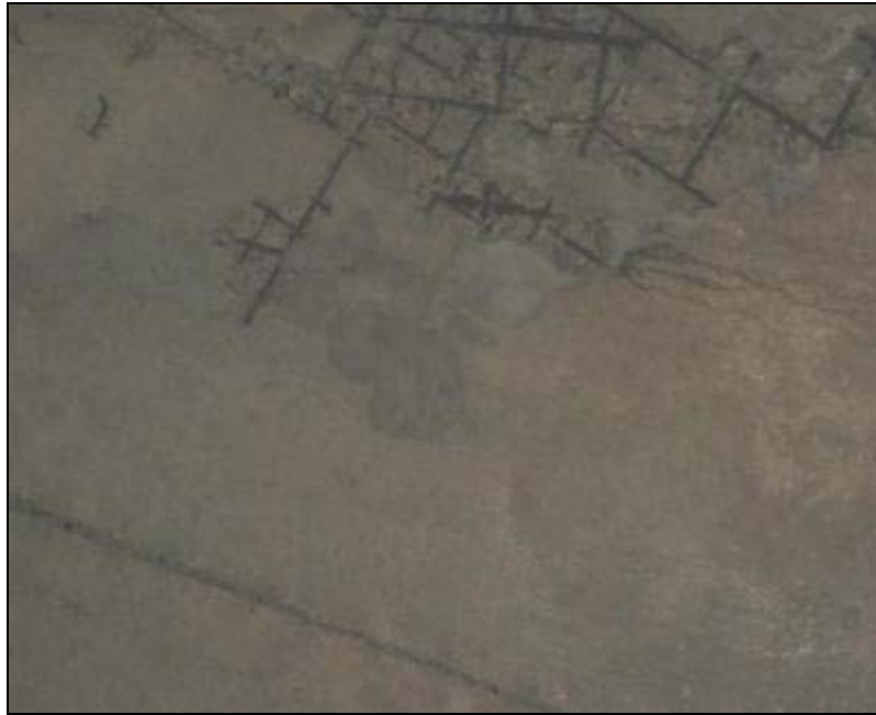
LOZA DE TECHO CON DEGRADAMIENTO DE CONCRETO (CR-326) R-5, SE APRECIA ARMADURA DE ACERO SUSPENDIDA
