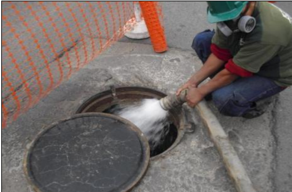
PURGADO EN LINEA RED, SE APRECIA EVACUACION DE FLUJO DE AGUA A BUZON.
