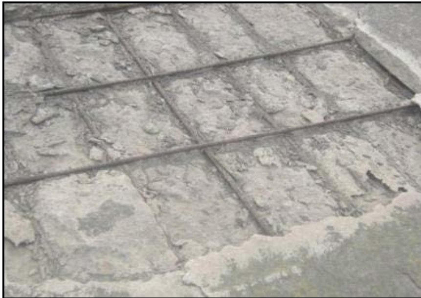
TECHO EXTERIOR DEGRADACION DEL CONCRETO EN EL RESERVOPRIO R-10 (CR-322) EL CUAL PODRIA COLAPSAR EN CUALQUIER MOMENTO. ESTRUCTURA DE TECHO EN EMERGENCIA
