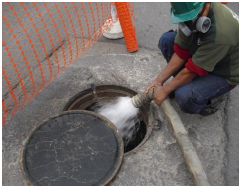
Foto N° 28 Purga de un grifo contra incendio,
