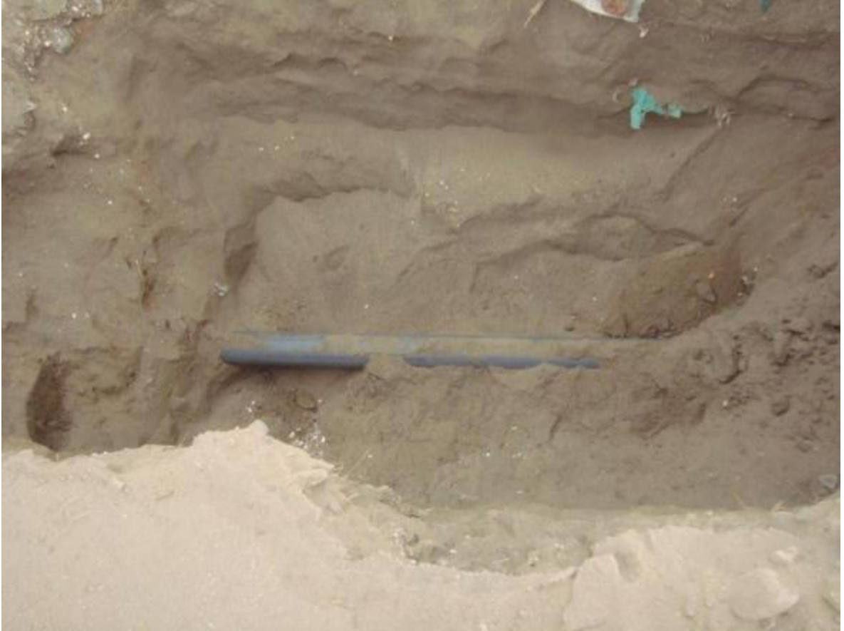
Foto N° 56 La tubería de agua pvc se ve de manera parcial, se encuentra a una profundidad de 2.50 metros de altura, se requiere escalera para que pueda descender los operarios a efectuar la reparación, en la parte de arriba hay personal que tiene que estar a la expectativa por si ocurre un deslizamiento de la arena.
