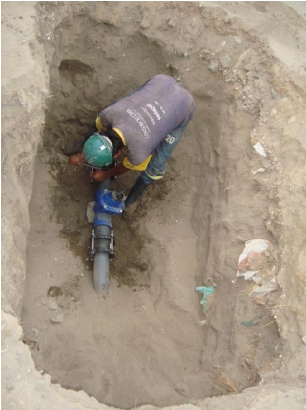
Foto N° 57 En la foto se aprecia al operario que ya hizo casi al 100% la reparación hidráulica en La rotura de la tubería pvc de agua.
