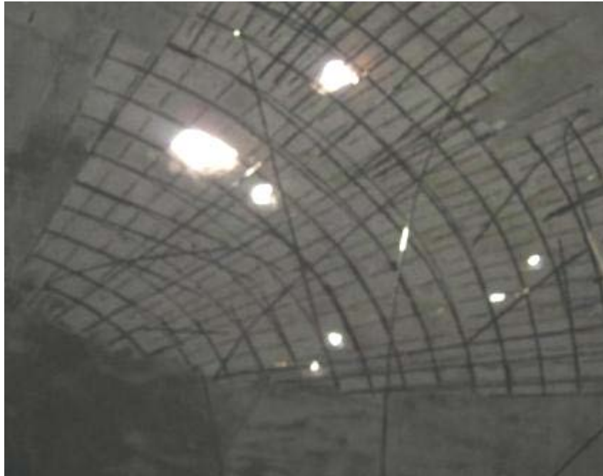
TECHO DEL RESERVORIO R-14 CON PERFORACIONES POR DEGRADACION DEL CONCRETO, SE APRECIA ARMADURAS DE FIERRO SUSPENDIDAS Y EXPUESTAS A LA CORROSION.
