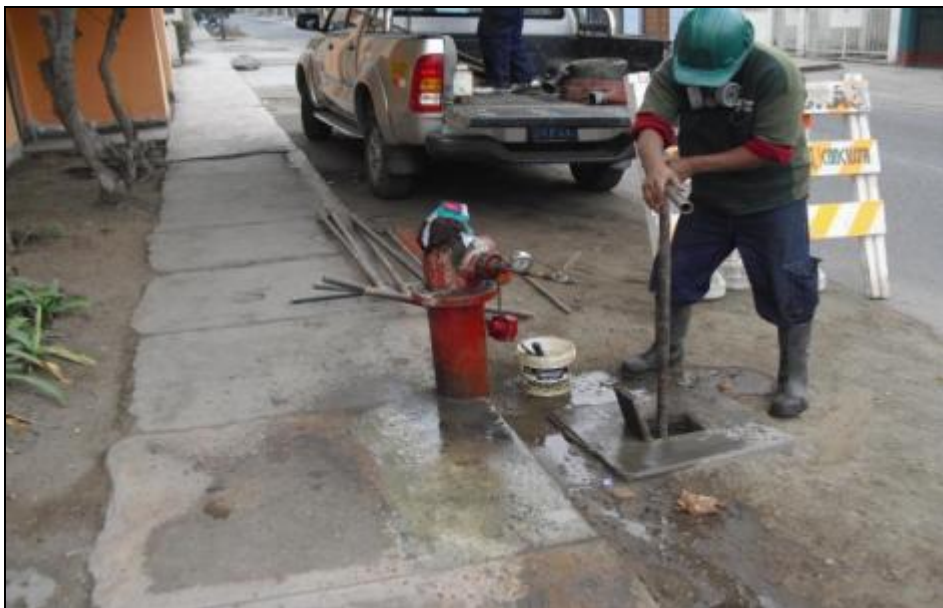
PURGADO DE REDES MEDIANTE USO DE GRIFOS CONTRA INCENDIO, SE APRECIA APERTURA DE VALVULA.
