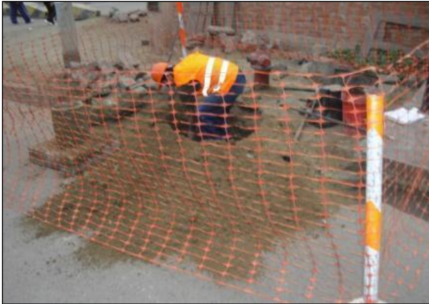
MANTENIMIENTO DE VÁLVULAS Y GRIFOS, SE APRECIA COLOCACION DE SEÑALES DE SEGURIDAD.
