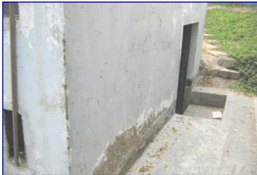
Foto N° 23 LAS PAREDES DE LAS CASETAS DE CONTROL SE ENCUESTRAN CORROIDA POR EL SALITRE
