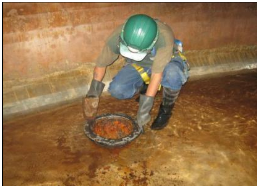
LIMPIEZA DE TUBERIA DE ADUCCION CON OXIDO Y SIN CANASTILLA EN EL RESERVORIO RP-3
