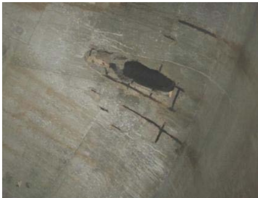
PERFORACION EN EL TECHO DEL RESERVORIO R-14 DEBIDO A LA DEGRADACION DEL CONCRETO, SE APRECIA ARMADURAS DE FIERRO EXPUESTAS A LA CORROSION.
