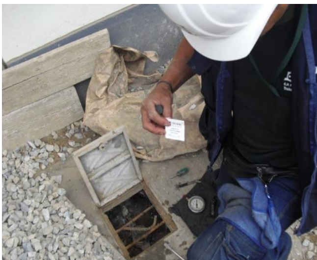
Foto N° 32 Toma de muestra de Cloro
