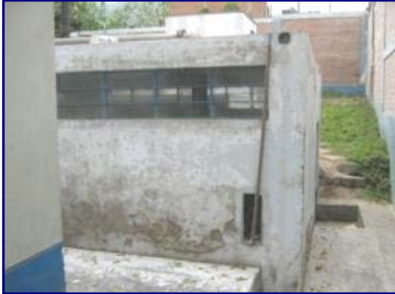
Foto N° 21 CASETA DE CONTROL
