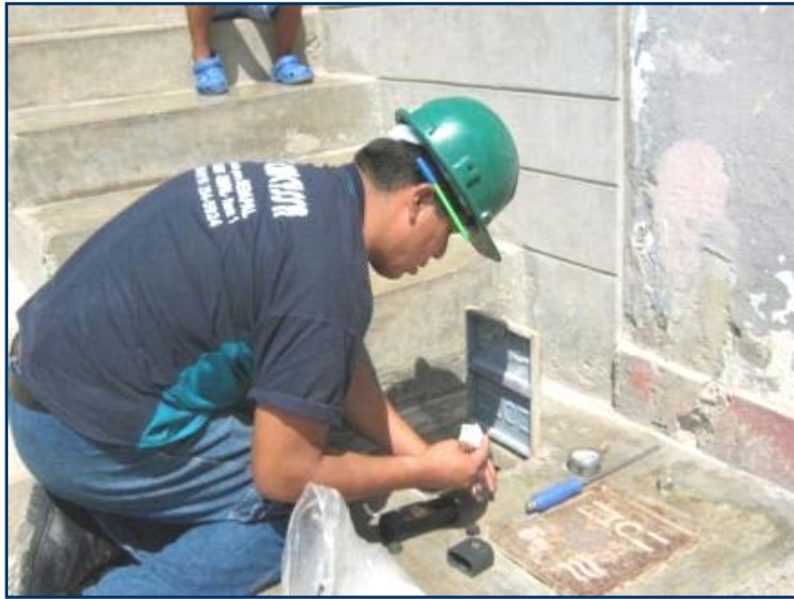
Foto N° 64 Se observa al operario encargado de tomar las presiones y tomar el cloro En las conexiones de los usuarios, dichos datos entrega diariamente al supervisor, el Cual llena en una base de dato que se entrega al final del mes en un informe técnico.
