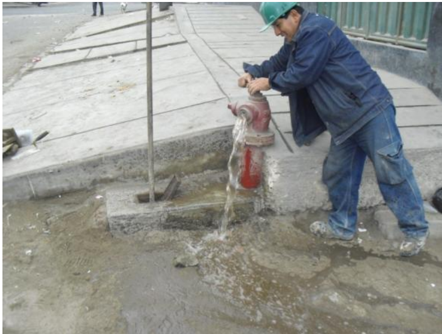
Foto N° 41 Grifo contra incendio operativo
