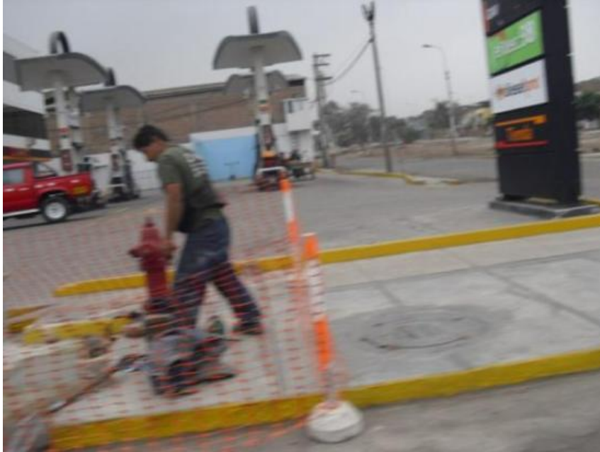
Foto N° 04 Mantenimiento preventivo mayor del grifo contra incendio
