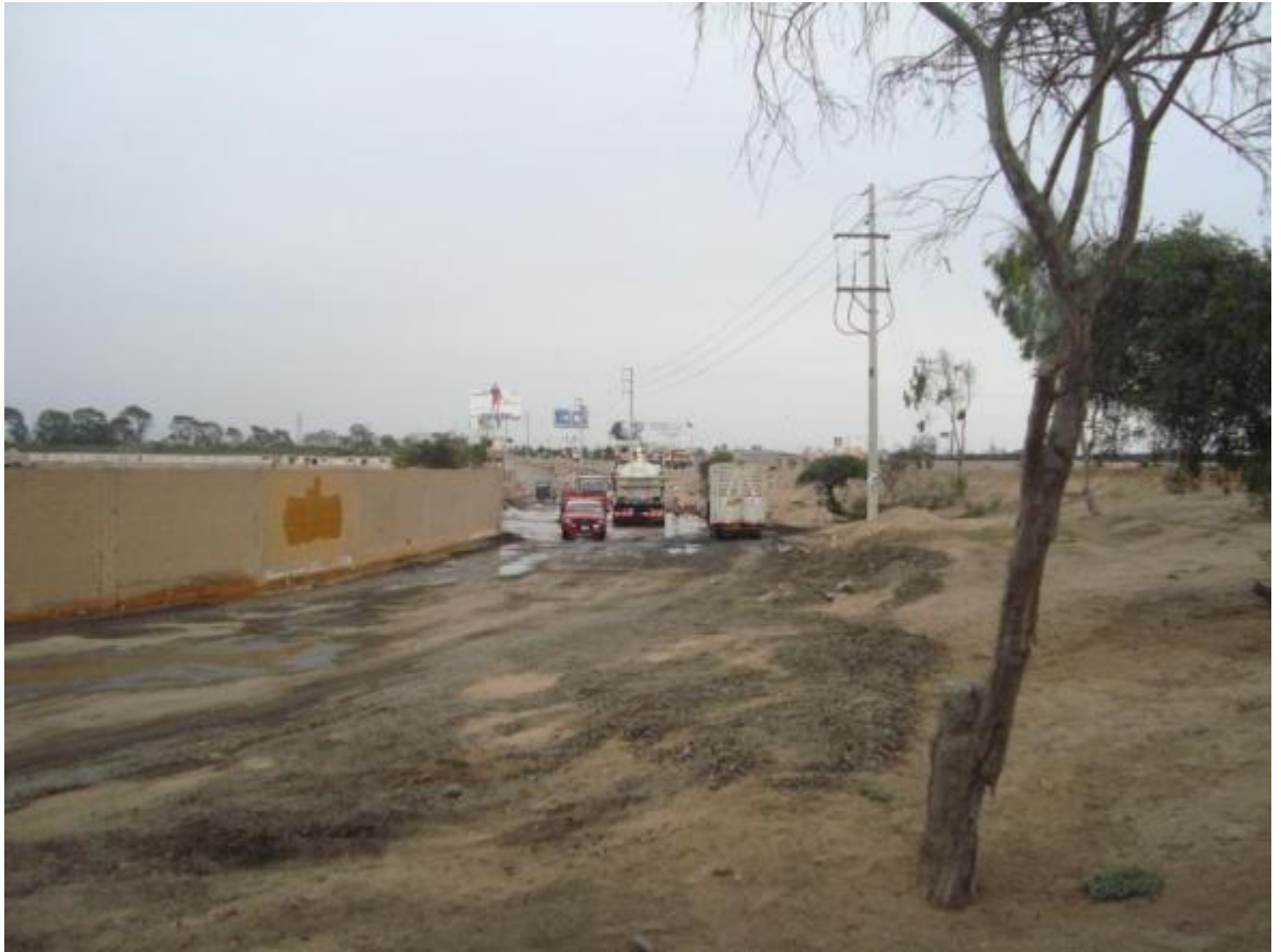
Foto N° 60 Se ve un aniego provocado por el colapso de una tubería esto genera un trabajo correctivo para la contratista.
