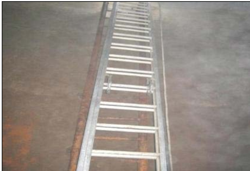
PARA INGRESAR SE REQUIERE NUEVA ESCALERA INTERIOR, LA ACTUAL ESTA TOTALMENTE CORROIDA (R- AMERICA)
