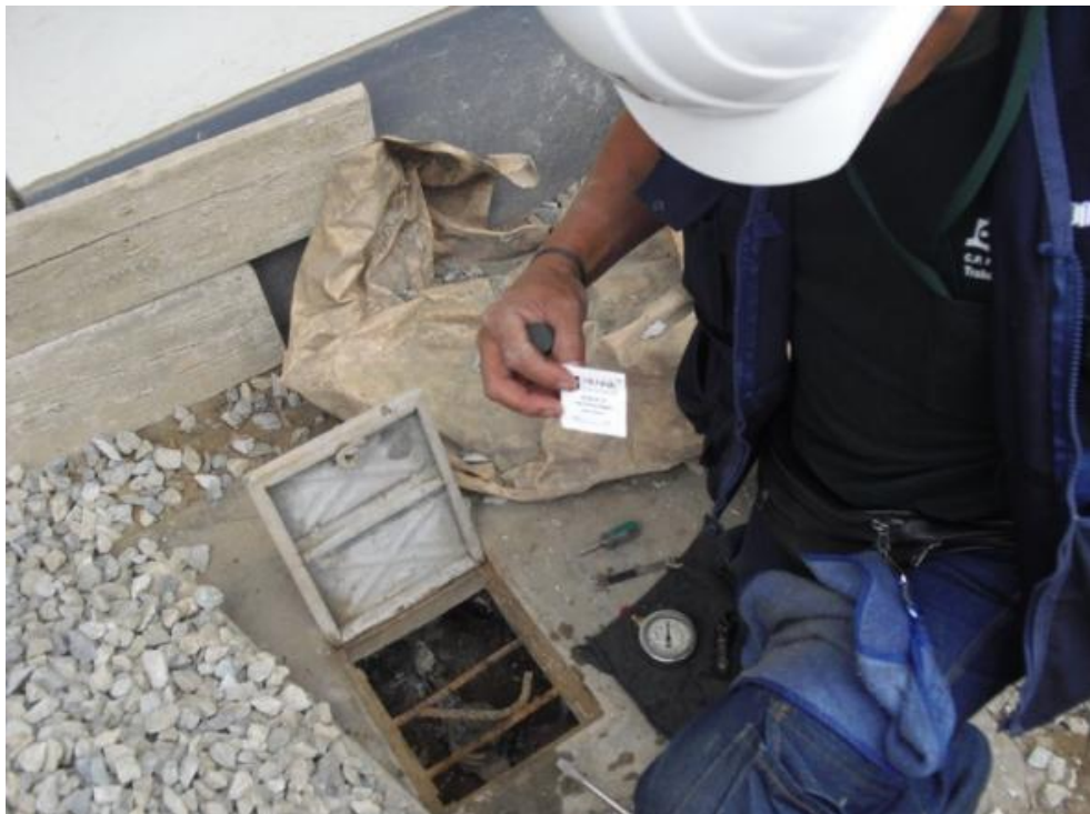
Foto N° 66 Se observa al operario tomando la muestra de cloro
