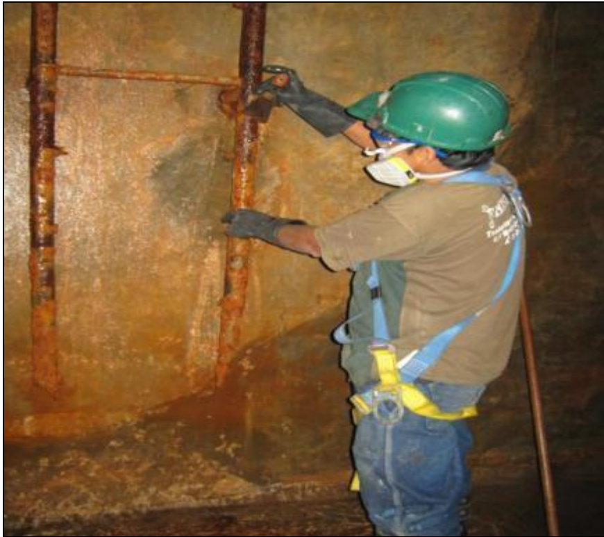
ESCALERA INTERIOR EN MAL ESTADO DEL RP-7
