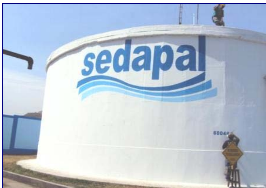
Foto N° 48 Rotulación de tanque cisterna
