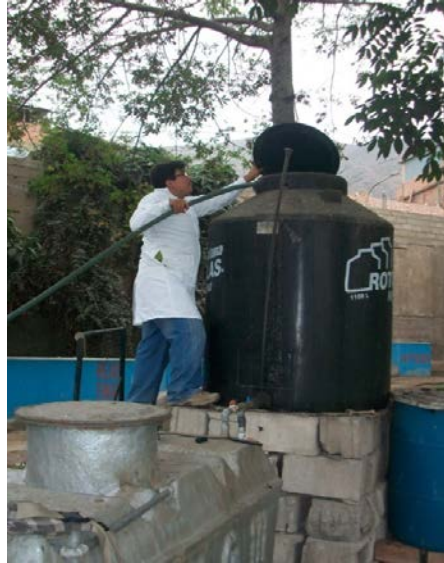
Foto N° 22 Tanque de almacenamiento
