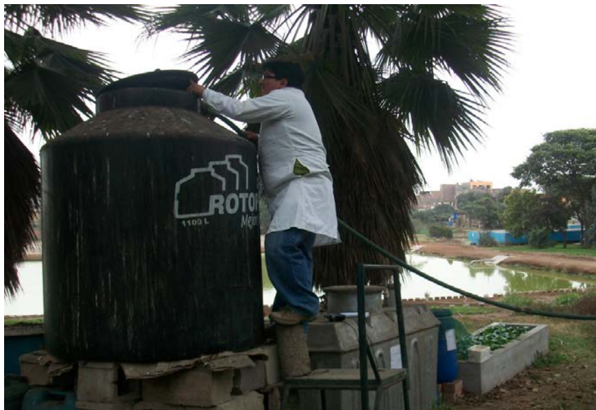
Foto N° 2 Bombeo de agua residual doméstica a tanque de mezcla y almacenamiento
