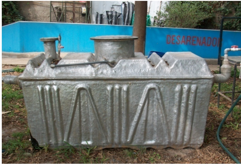
Foto N° 23 Tanque séptico - Reactor anaerobio
