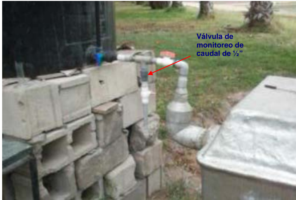
Foto N° 3 Vista de válvula de aforo de caudal
