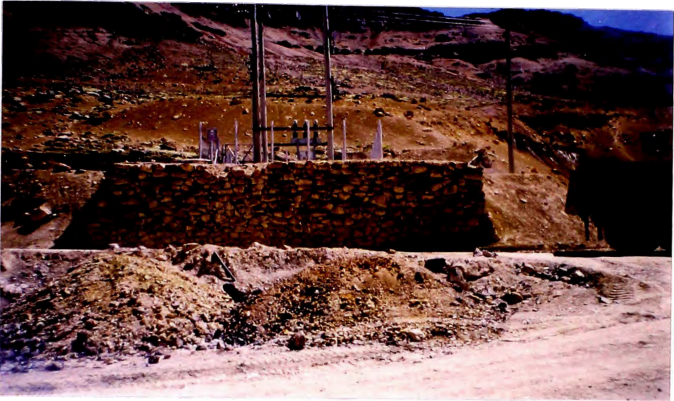
Foto N° 9: Base de subestación eléctrica.
