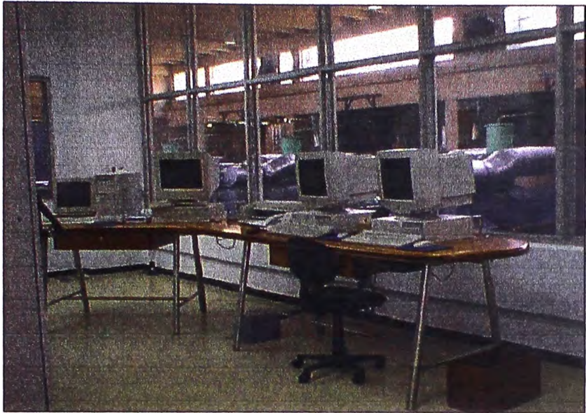
Figura N° 51 Cuarto de Control de la Central
