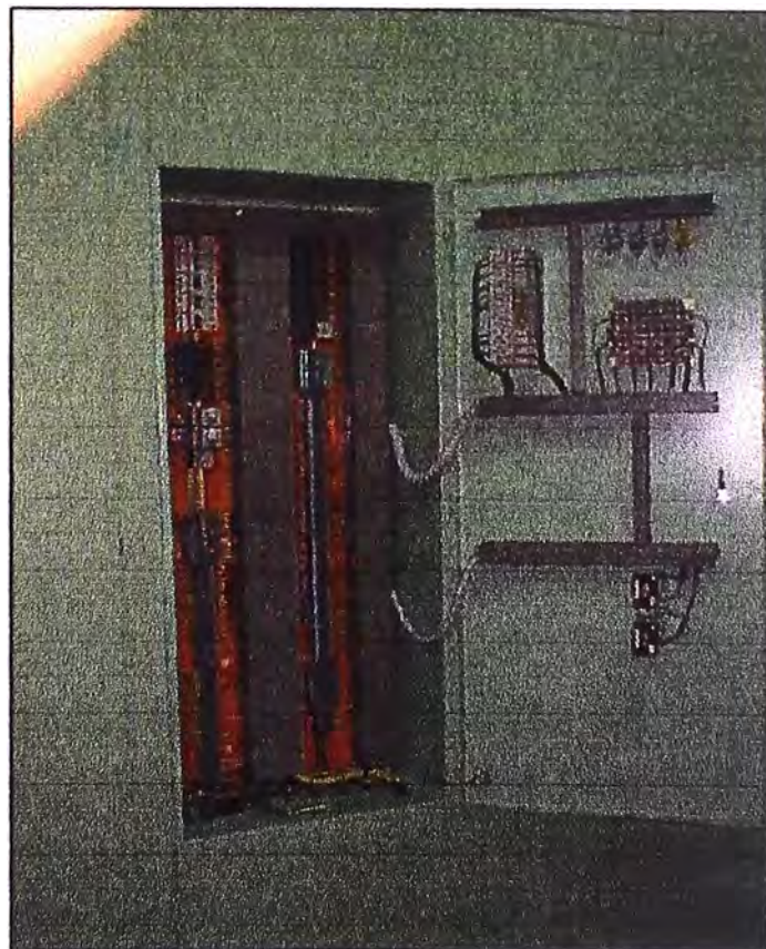
Figura N° 40 Vista del Interior del Compartimento de Control de la Celda de 60 kV
