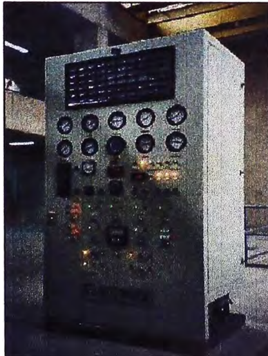
Figura N° 3 Panel de Control Local del Motor antes de la Ampliación
