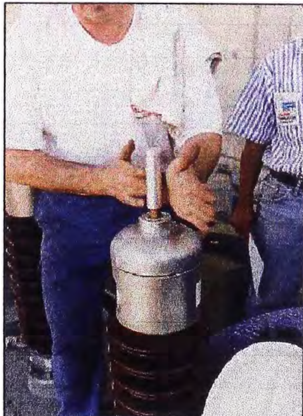
Figura N° 44 Acabado de la Borna de Alta Tensión del Trafo de 18 MVA
