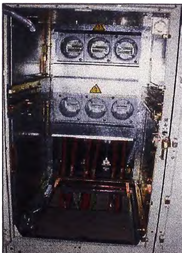
Figura N° 34 Vista Interior de una Celda de Media Tensión 8BK20 Siemens
