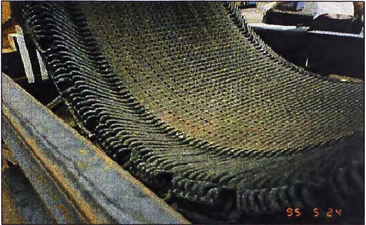
Figura N° 12 Estado de los Devanados de los Generadores a Instalarse.
