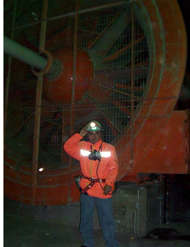
Figura 2.3: Ventilador de 1'000,000cfm Mina El Teniente - Chile
