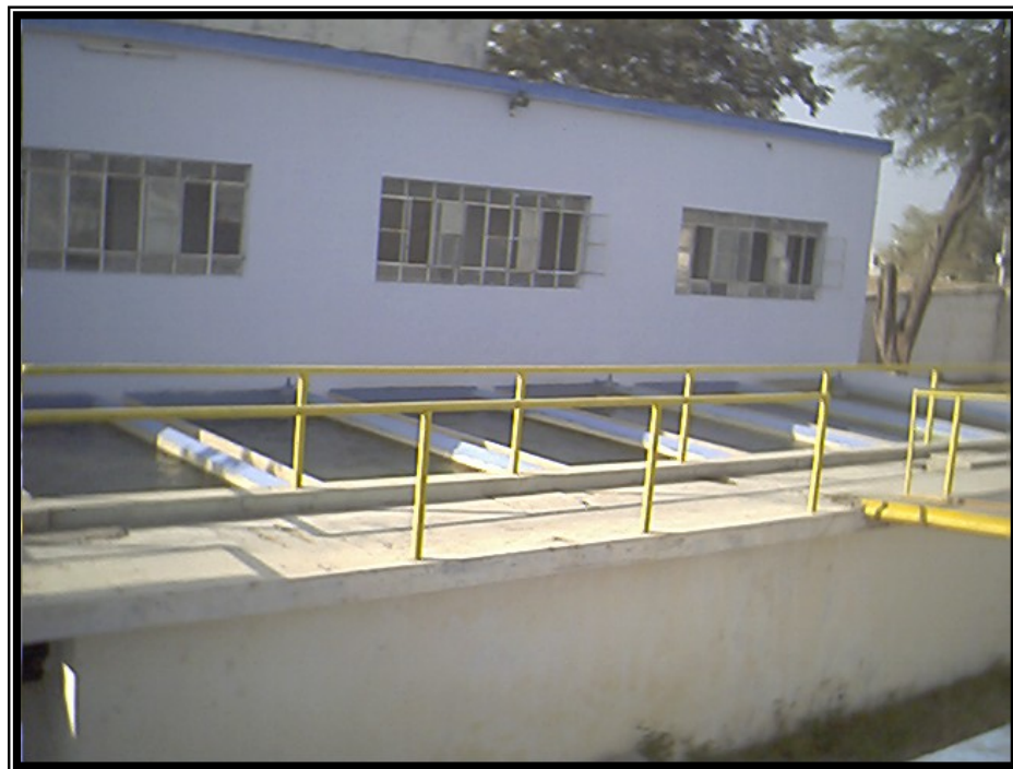
Planta de Tratamiento de Agua – Sullana – Piura – Unidades de Filtros
