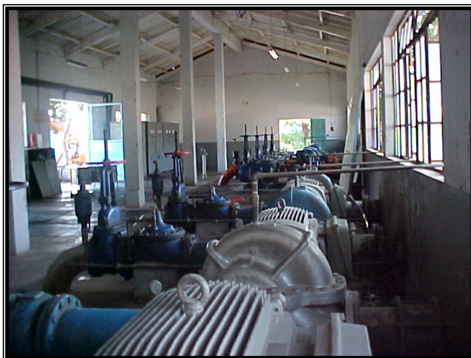
Planta de Tratamiento de Agua – Sullana – Piura – Estación de Bombeo
