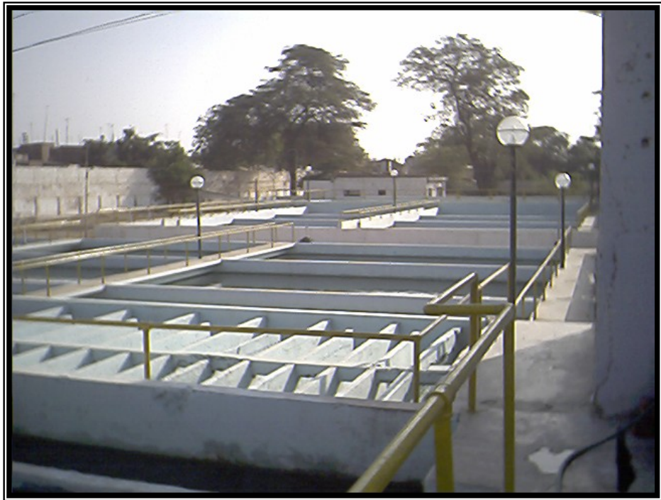
Planta de Tratamiento de Agua – Sullana – Piura – Unidad de Floculadores
