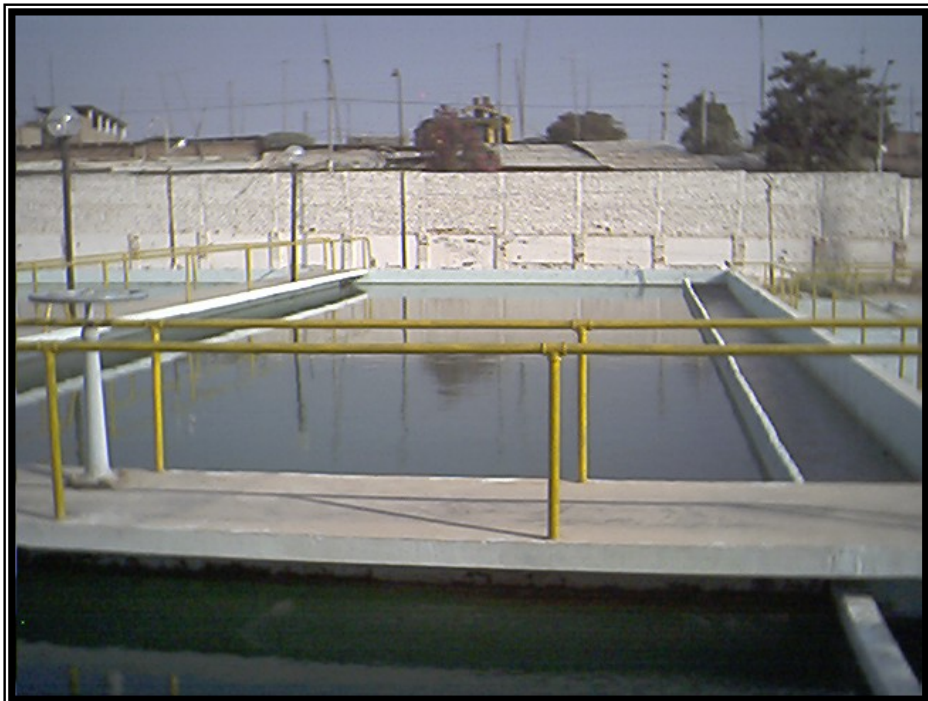
Planta de Tratamiento de Agua – Sullana – Piura – Unidad de Sedimentador
