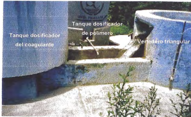
Tanques dosificadores de coagulante y polímero
