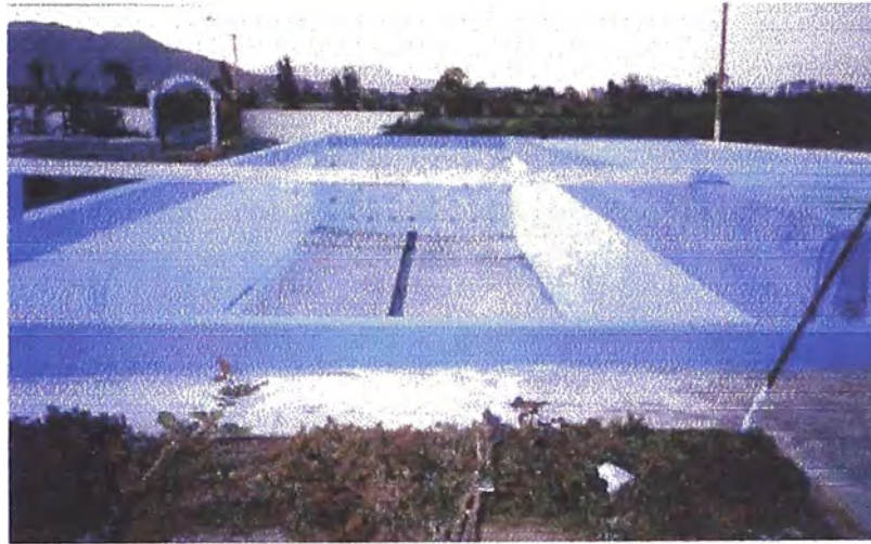
Unidad de Decantación
