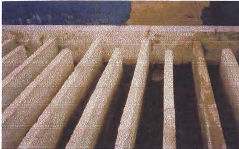
Baffles del 2do. compartimento de la unidad de Floculación
