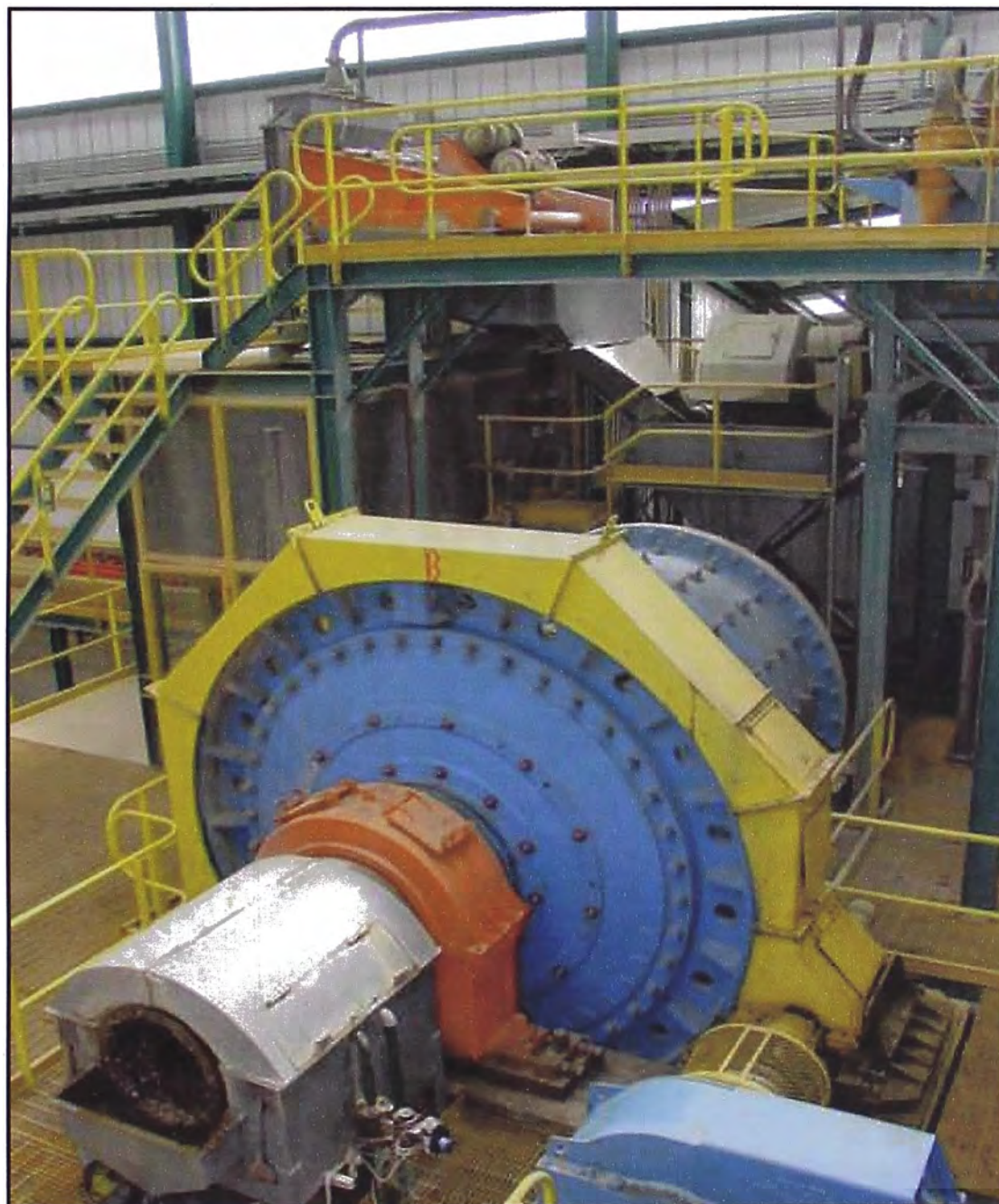
Molino de la planta de tratamiento
