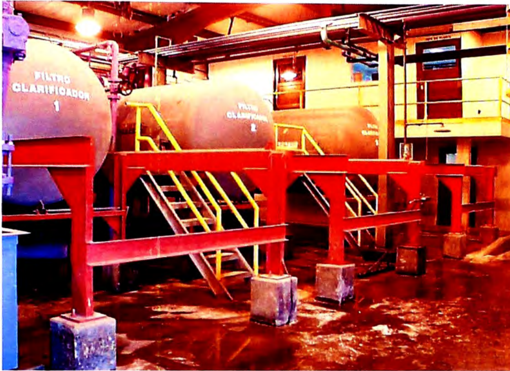
FOTO N° 19: FILTROS CLARIFICADORES PLANTA PAMPALARGA.
