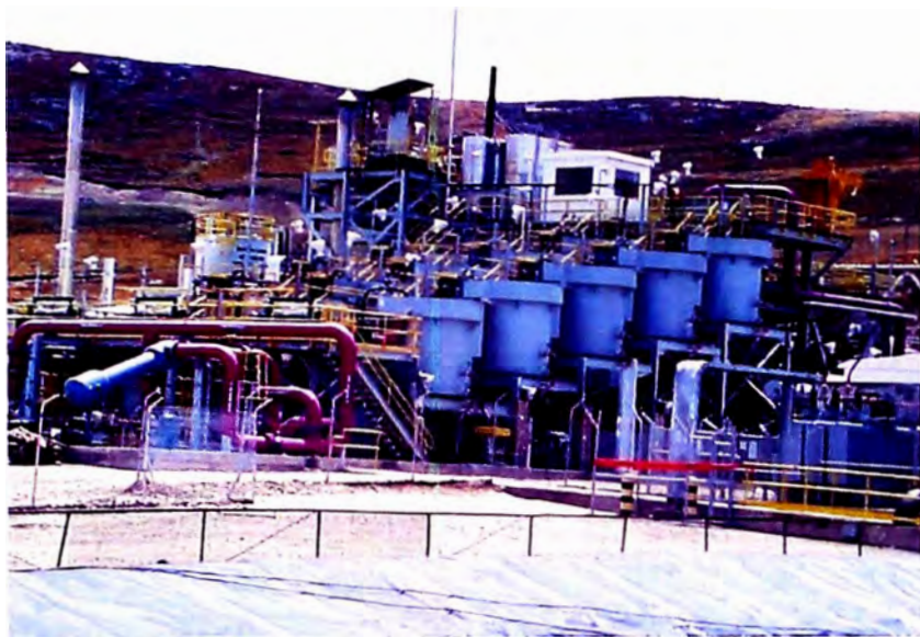
FOTO N° 17: PLANTA DE CARBON EN COLUMNAS - YANACOCHA NORTE
