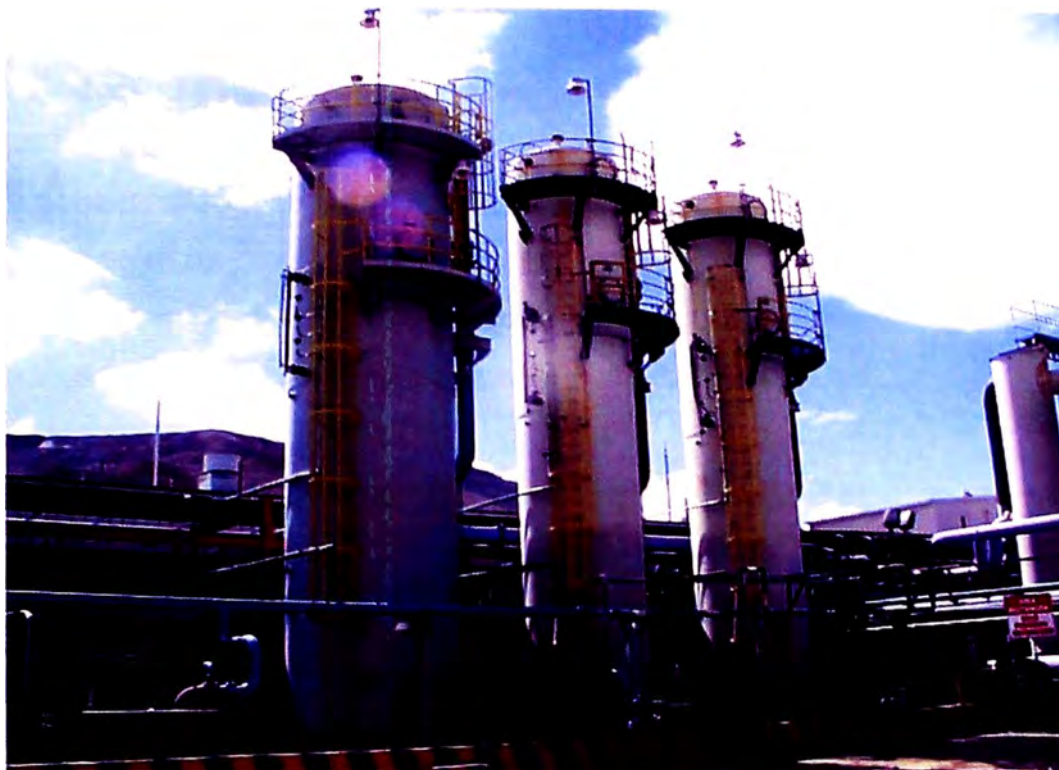
FOTO N° 20: TORRES DE VACIO PLANTA YANACOCCHA NORTE.
