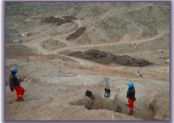
Foto 10: Medición de Puesta a Tierra – Telurómetro de alta frecuencia
