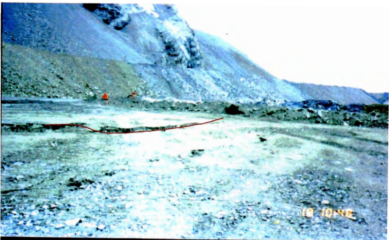
FOTO N °11: EN ESTA VISTA SE OBSERVA UN HUNDIMIENTO QUE SE PRESENTA EN LA PLATAFORMA DEL BOTADERO, CAUSADA POR LA MALA DISTRIBUCIÓN DEL MATERIAL
