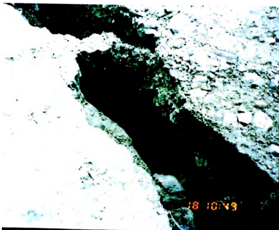
FOTO N °12: EN ESTA VISTA SE OBSERVA UNA GRIETA PRODUCTO DE LA MALA COMPACTACIÓN DEL MATERIAL.
