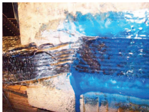
Foto 4.12 Fibras de carbono endurecidas rotas durante el inicio del ensayo-
