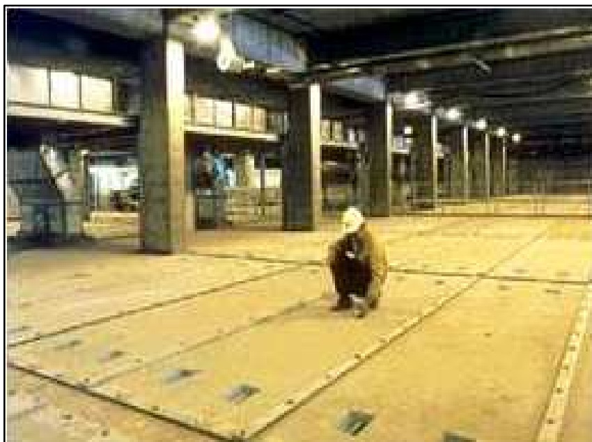
Figura 3.14: Canales cubiertos con tapas de fibra de vidrio
