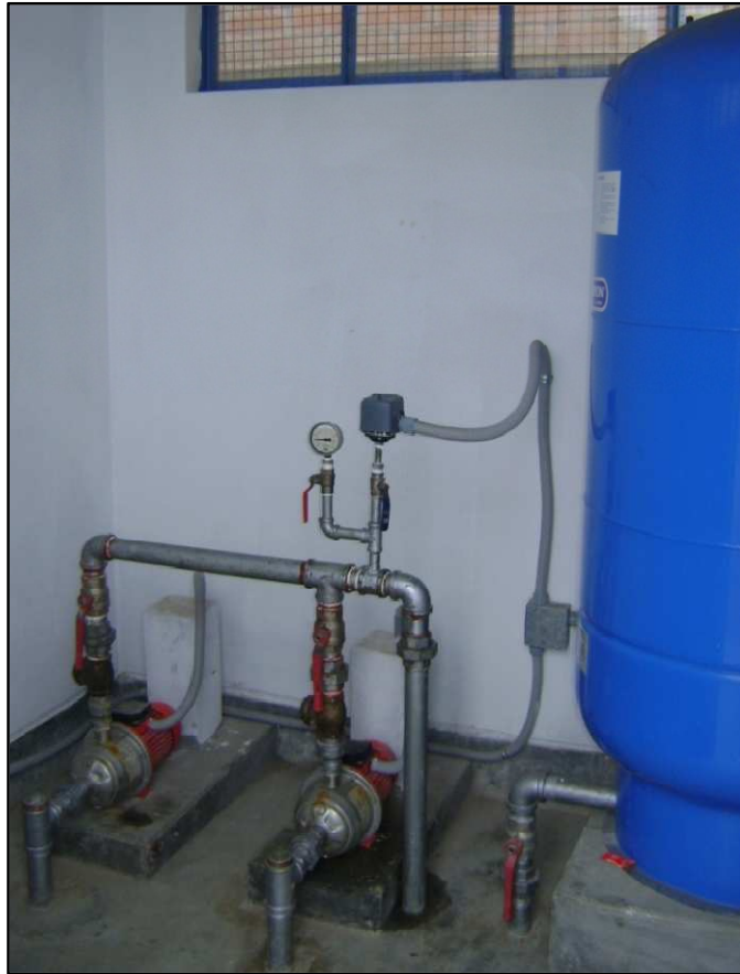
Figura 4.6: Equipos del sistema hidroneumático
