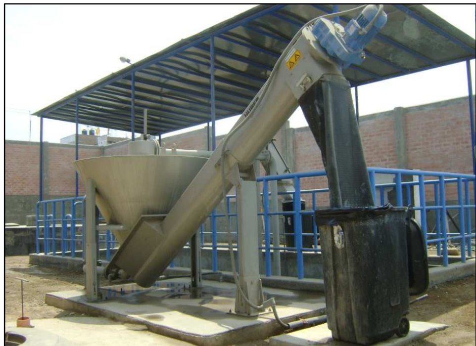
Figura 4.5: Equipo clasificador y lavador de arena
