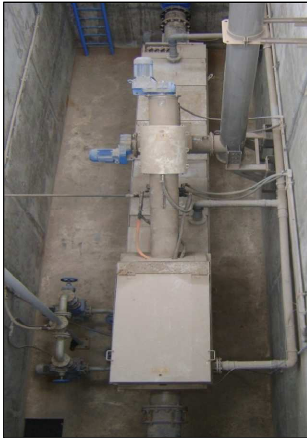
Figura 4.4: Tanque desarenador aireado
