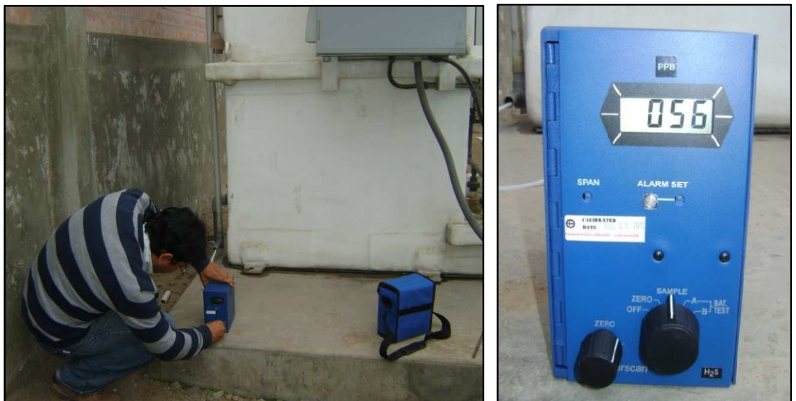
Figura 4.23: Instalación del analizador Interscan en el punto de muestreo G2
