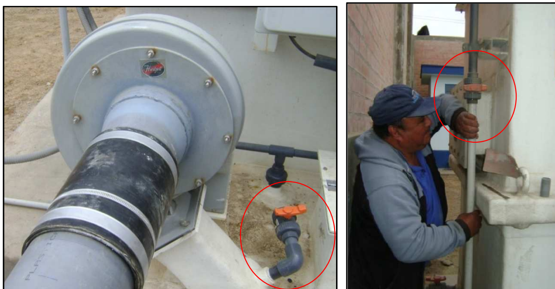
G1: Ingreso del extractor
