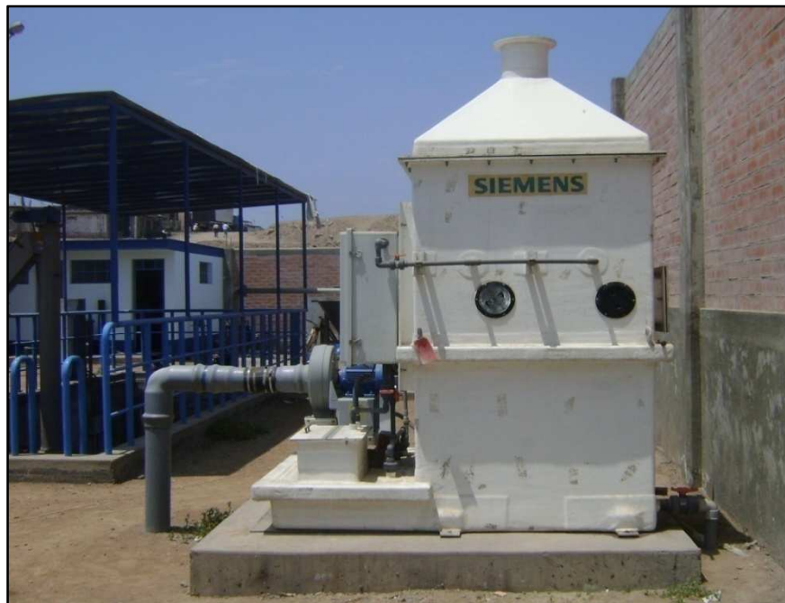
Figura 4.9: Biofiltro fabricado en fibra de vidrio reforzada
