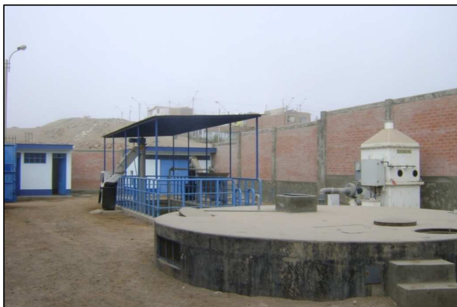
Figura 4.1: Vista panorámica de la Estación de bombeo CBD 326-2
