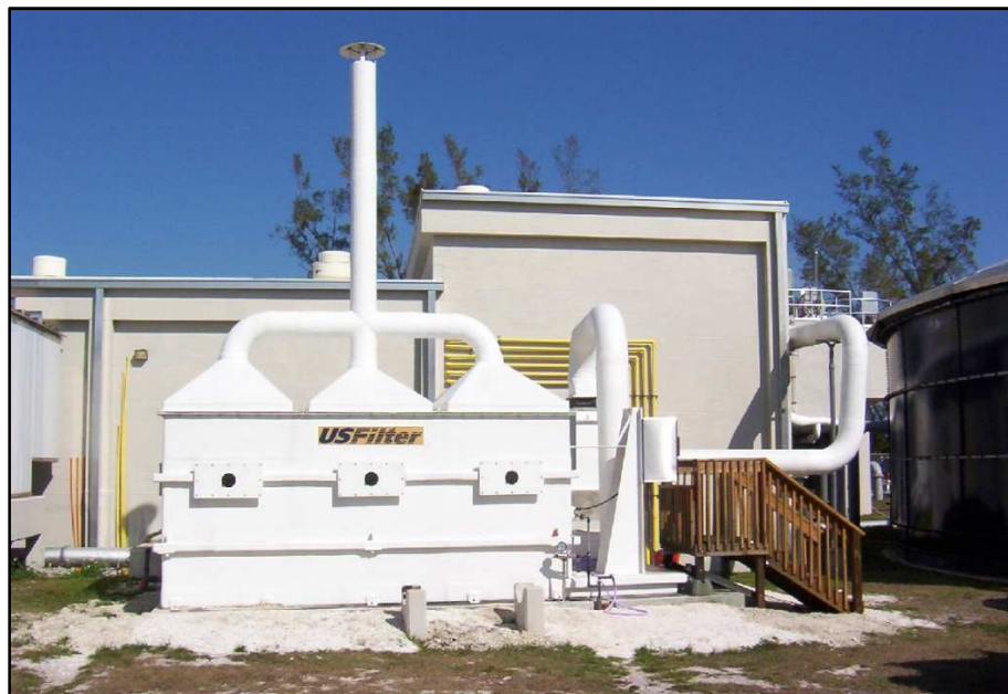
Figura 3.13: Sistema de pretratamiento instalado dentro de una caseta de fibra de vidrio.
