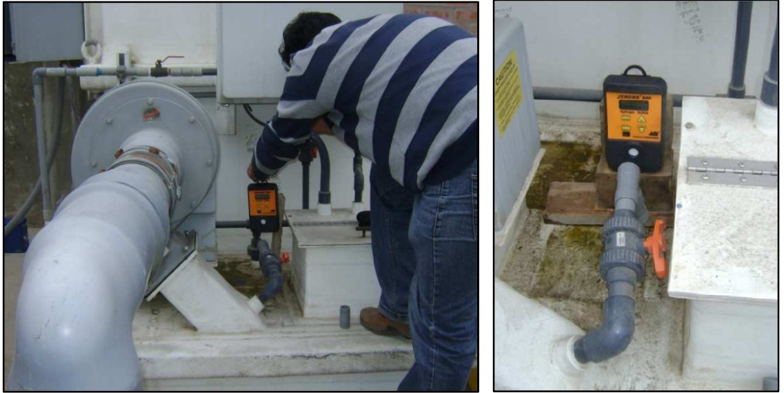
Figura 4.22: Instalación del analizador Jerome modelo X860-001 en el punto de muestreo G1.
