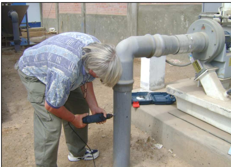
Figura 4.18: Perforación de orificios en el ducto para la medición de la velocidad del aire.
