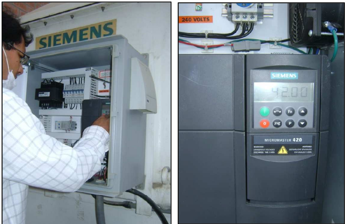
Figura 4.16: Programación del variador de frecuencia y regulación del flujo del extractor.
