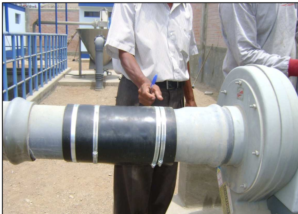
Figura 4.15: Instalación de acople flexible delante del extractor centrífugo.
