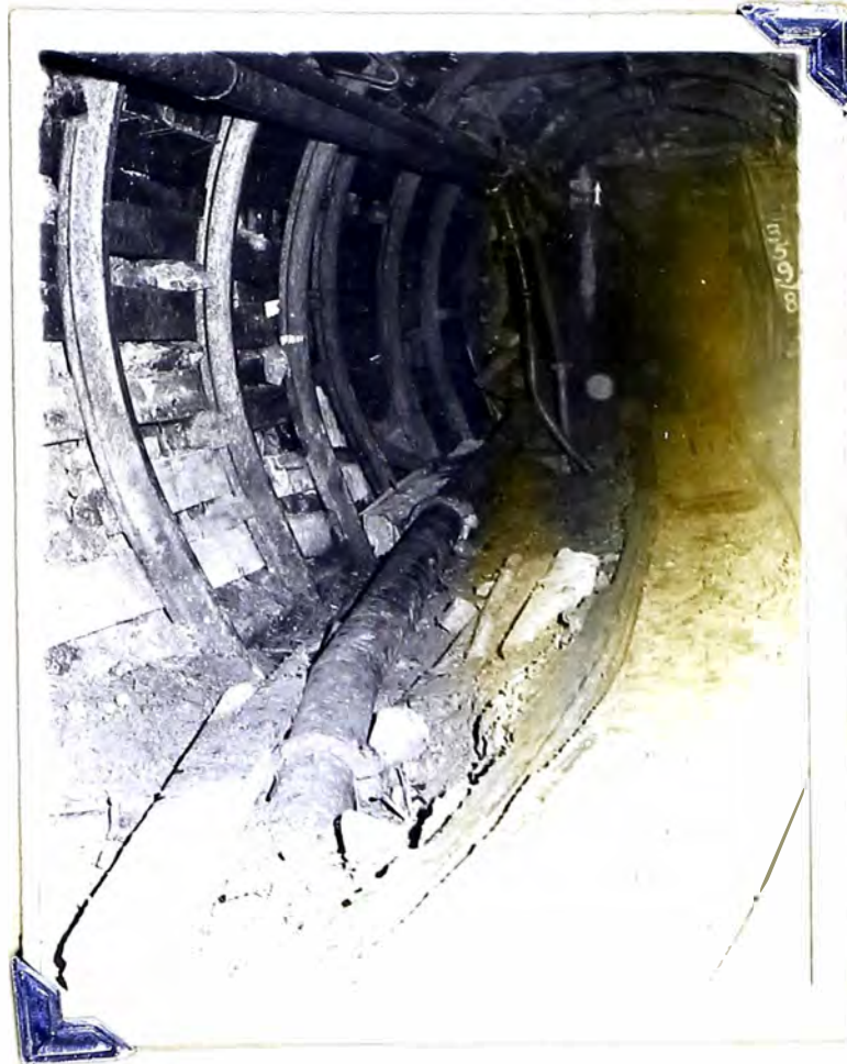
Tubería troncal pasando debajo de la línea decauville
