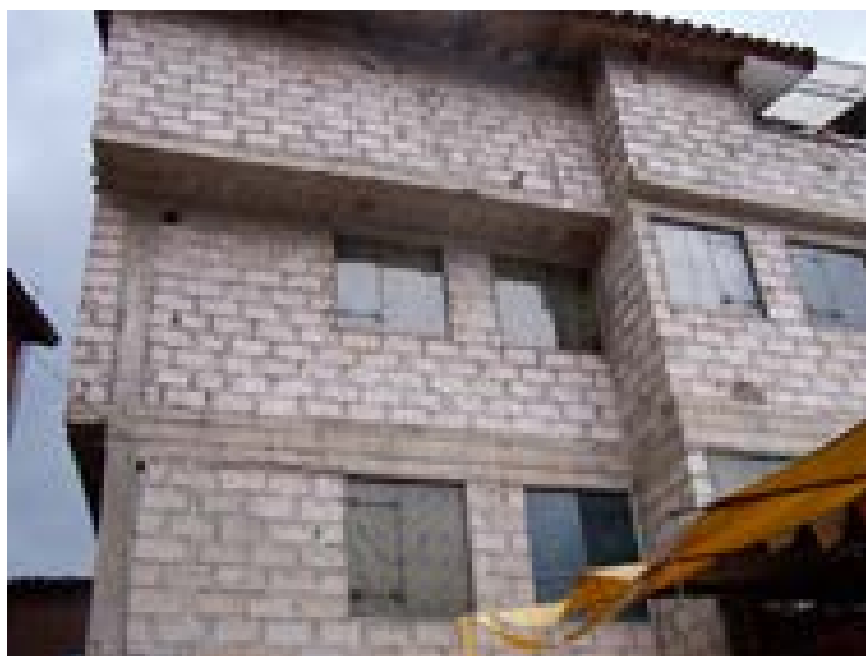
Construcciones que alteran la fisonomía del entorno del Centro Historico
