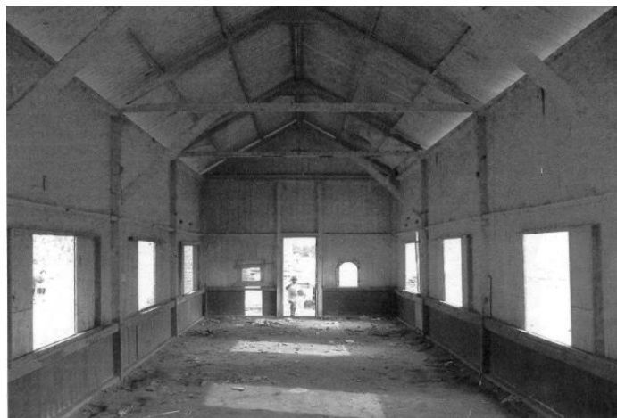
Foto del interior de la Caseta.
