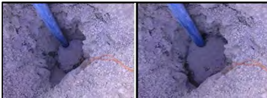
Fig N° 7.7 Muestra el bombeo de la mezcla explosiva en taladros con presencia de agua
