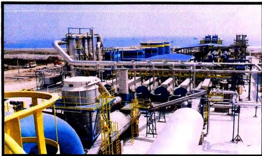
Fig. 2.2 Vista de una planta típica de Producción de Harina de Pescado ubicada frente al mar
