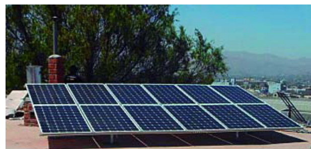
Figura 9. SFCR de 3kW p hecho con módulos FV de silicio cristalino e inversor Steca (Ubicación: Arequipa)
