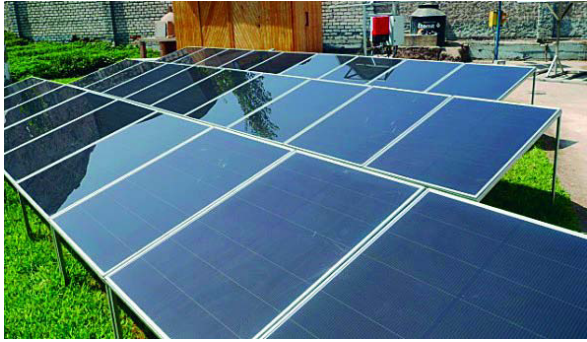
Figura 11. SFCR de 3,5kW p hecho con módulos FV de película delgada ( \alpha Si/ \mu Si) e inversor SMA (Ubicación: Lima, LES-CER)
