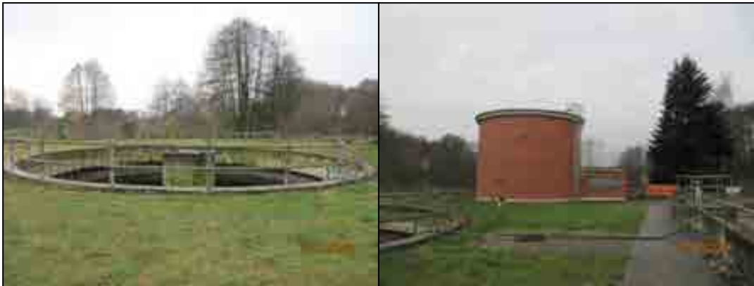
Figura 9: Se muestra a la izquierda el lecho de secado y a la derecha el digestor de lodos (Año 2009)
