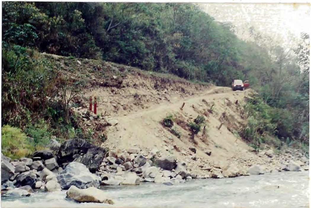
FOTO Nº 9: Depósito coluvial, clasificado como suelo, ubicado en las progresivas 0+300 0+400 de la Variante Chimay.
