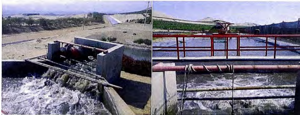
Figuras 3.3 Sistemas de tratamiento de agua.
