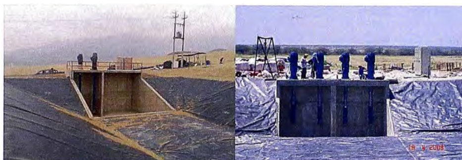
Figura 3.4 Casetas de bombas verticales
