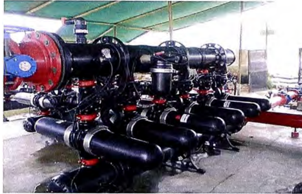
Figura 3.5 Sistema de filtrado de agua
