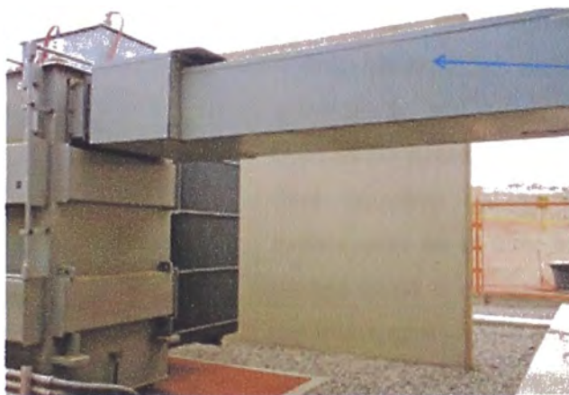
Ducto de Barras de 3000A, 4.16kV.
