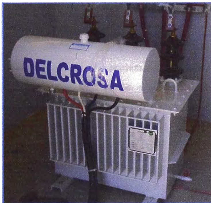
Figura 2.6 Transformador de servicios auxiliares 22.9kv
