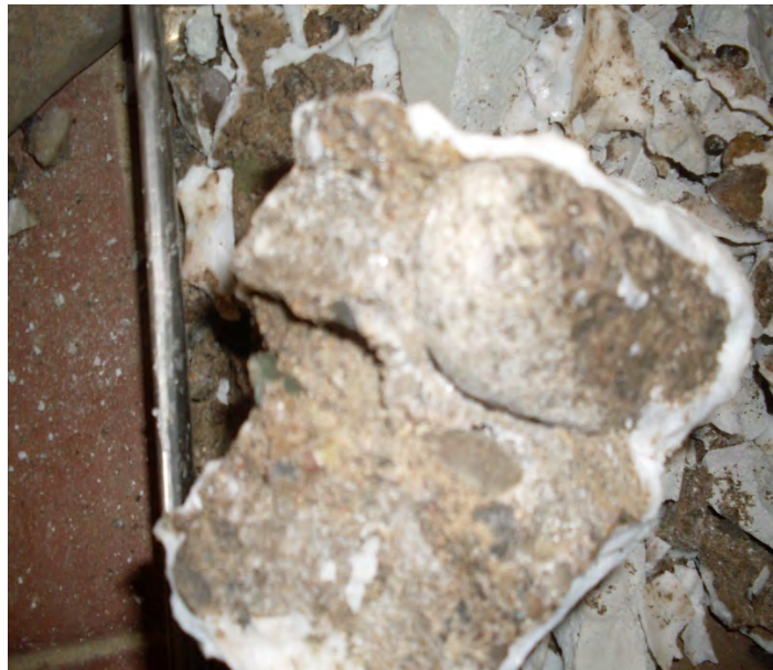
(c) Muestra colapsada
