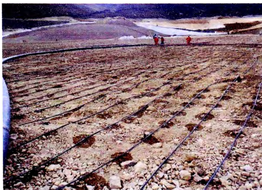
Figura N° 3.1 Pad de Lixiviación
