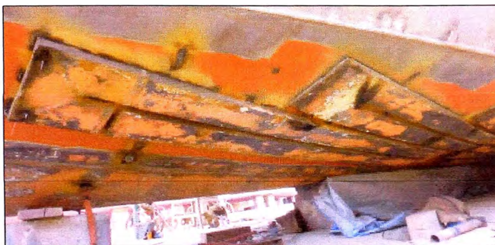
Figura 29. Sistema de enfriamiento por canaletas de acero.
