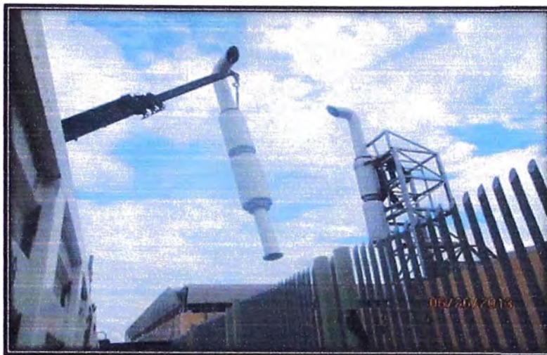
Figura 5.30 Izaje de segunda línea tubería de escape de 10 "Ø con resonadores de 12" Ø
