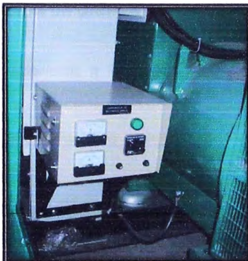
Figura 5.35 Cargador de baterías con instrumentos 24V-05 Amp
