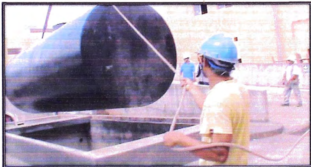
Figura 5.13 Tanque de almacenamiento de 3000 gal - soterrado
