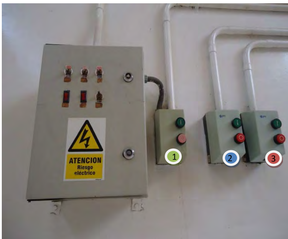
Figura 4.36: Botones de extractores del área de caramelizado.
