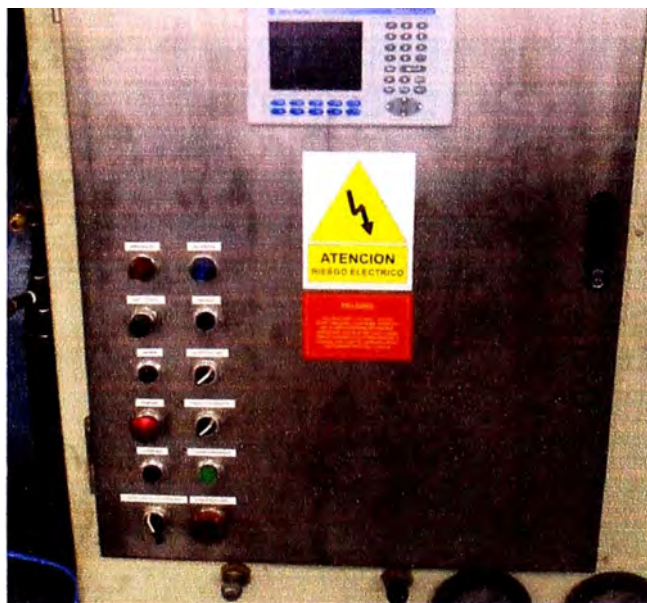
Figura 3.6 Puerta de gabinete de PLC con Panel View
