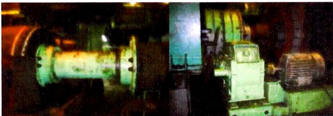
Fig.3.21: Motor eléctrico principal, acciona al reductor, de ahí con eje de transmisión de potencia mecánica acciona al molino de bolas cilíndrico tubular de 14'Øx41', Nordberg, para molienda fina y húmeda de mineral:
