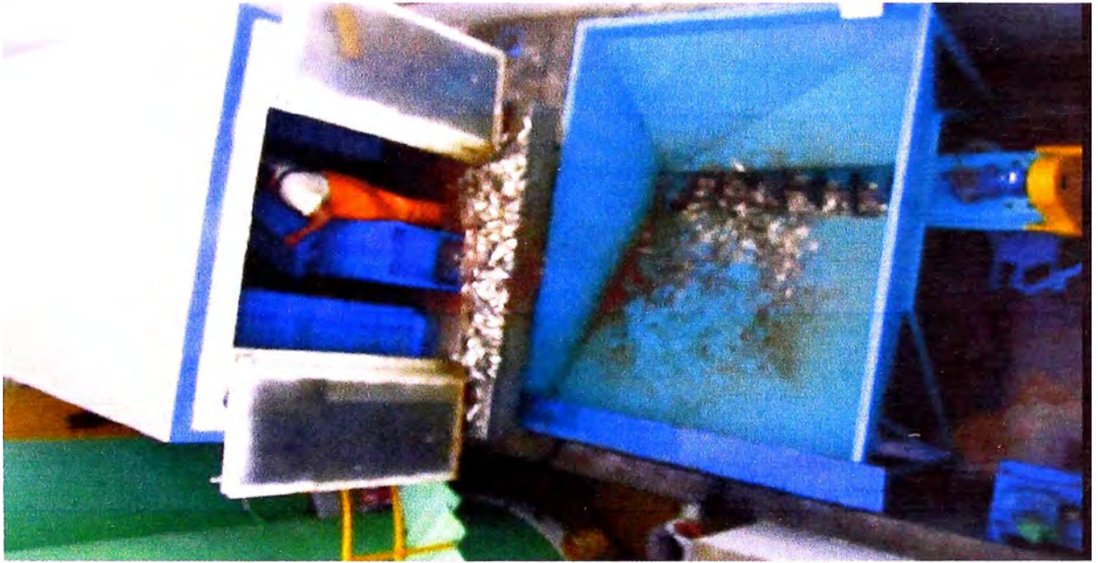
Figura 2.1. Poza metálica de recepción.
