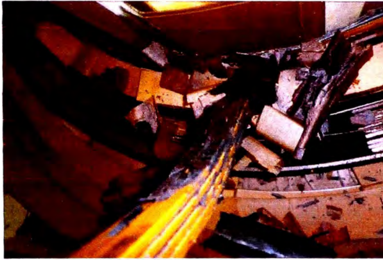
Figura 4.3. Salidas de baja tensión sobrecalentadas y aislamientos deteriorados
