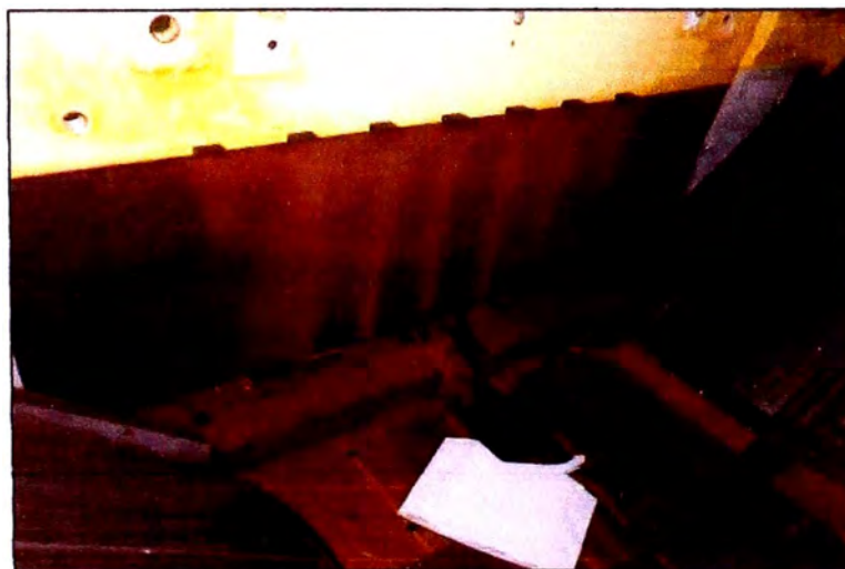
Figura 4.2. Aislamientos de cartón quemados, degradados
