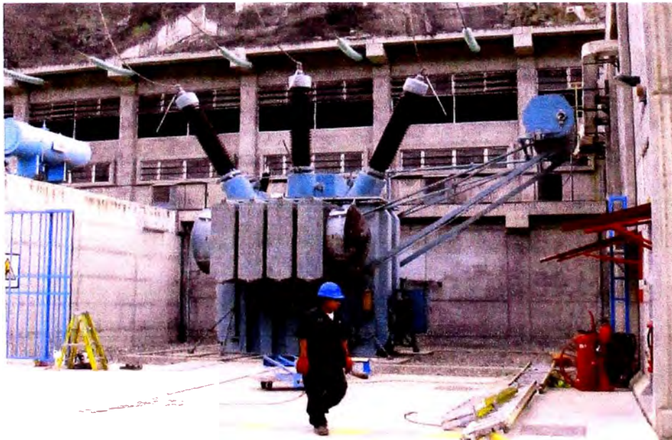
Figura 4.4. Transformador en la central Carhuaquero
