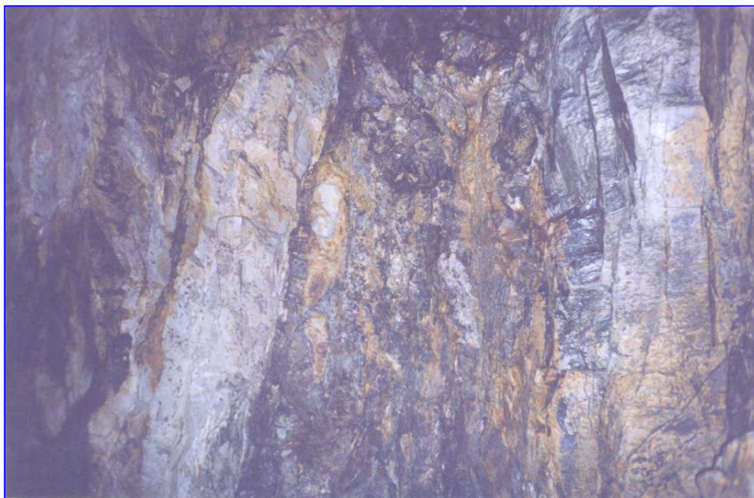
FOTO 13: Vista de las paredes de la galería del Nivel 575, se observa las juntas y diaclasas lavadas por la acción del agua.
