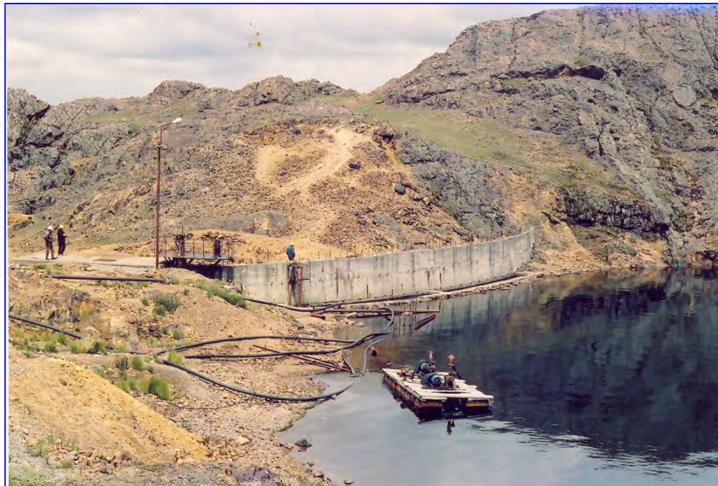
FOTO 12: Vista Laguna Llacsacocha, mostrando el dique y sistema de bombeo entre las lagunas.
