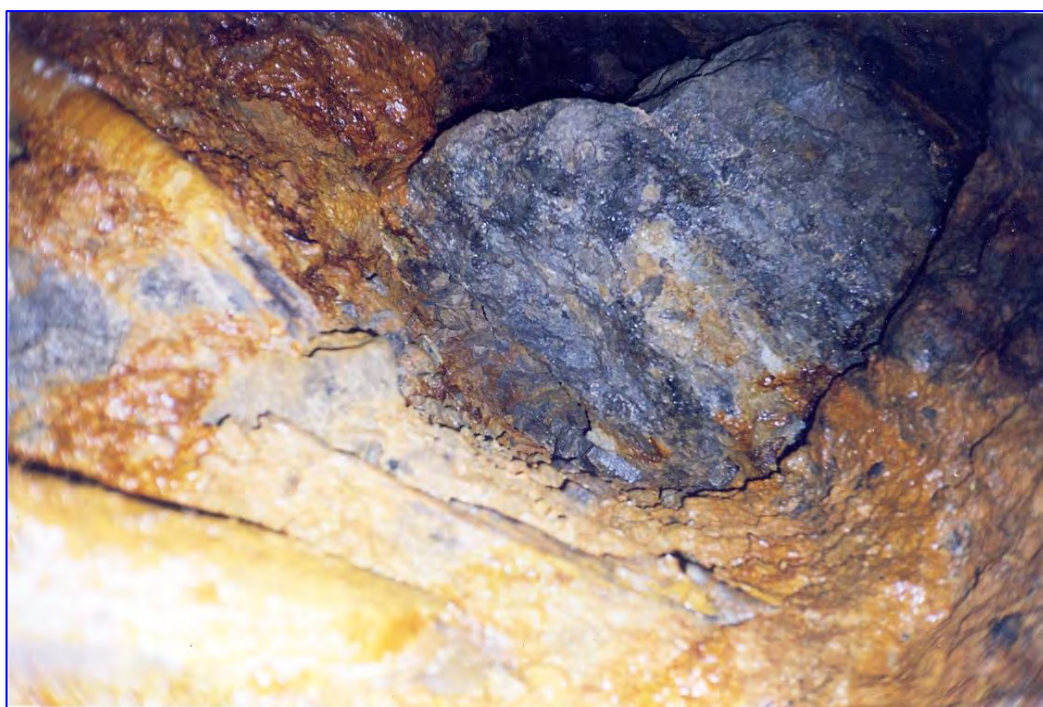
FOTO 14: Vista del buzón del tajo 44E desde el Nivel 575, obsérvese que se encuentra totalmente saturado, a pesar de haber pasado un año.
