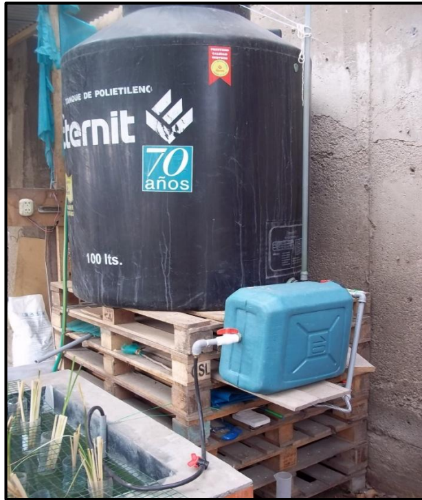
Figura 8: Tanque de almacenamiento de 1100 L y dispositivo regulador de caudal. (Fuente propia)
