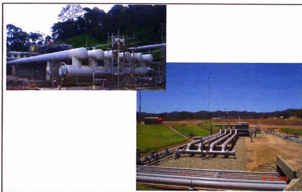
Figura 3.10 – Slug Catcher instalados en planta
