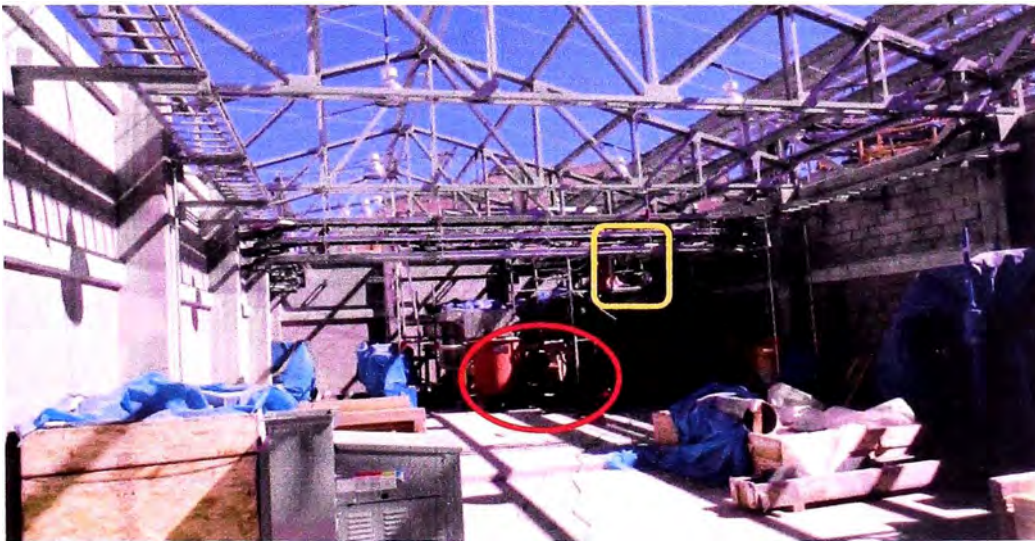
Figura 4,2 Interferencia en trabajo de montaje eléctrico
