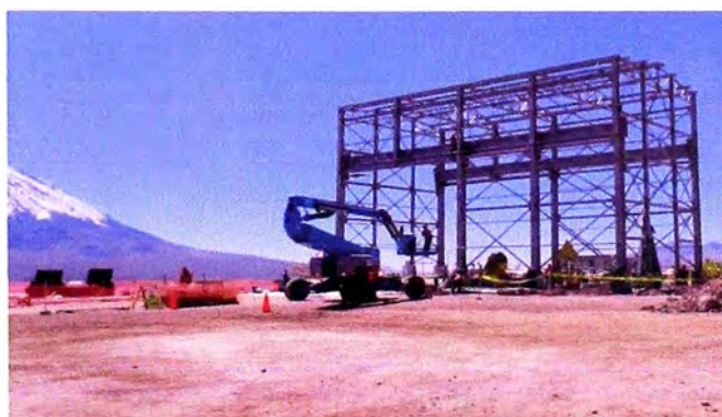
Figura 2,5: Vista del Puente Grúa.
