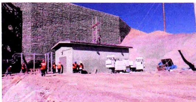
Figura 2,10: Vista de la Sala Eléctrica N°04
