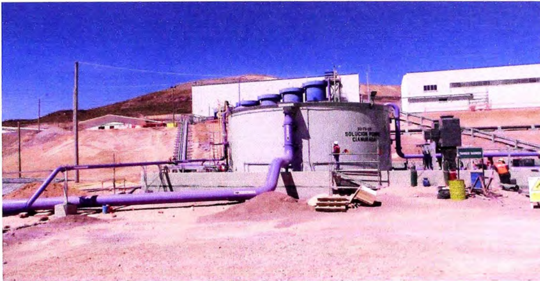
Figura 2,19: Vista del Tanque Barren
