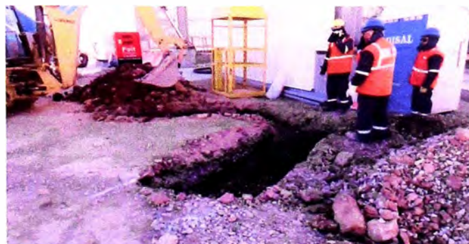
Figura 4,3 Retrabajos en Sistema de puesta tierra
