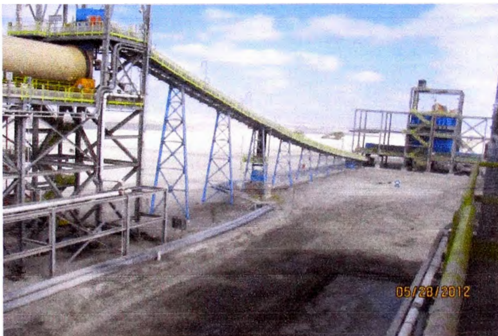
Figura P7 : Tubería de relaves en planta concentradora
