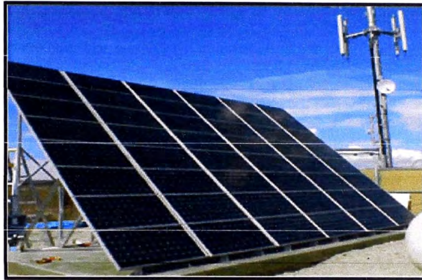
Fig. 2.19 Alimentación Fotovoltaica Para Energizar Equipos de Comunicación
