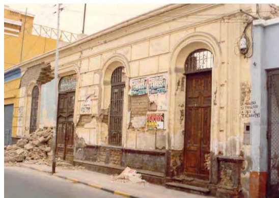
Foto 1.4 - Colapso parcial de estructura de adobe. Ica, 1997. Foto D. Torrealva.
