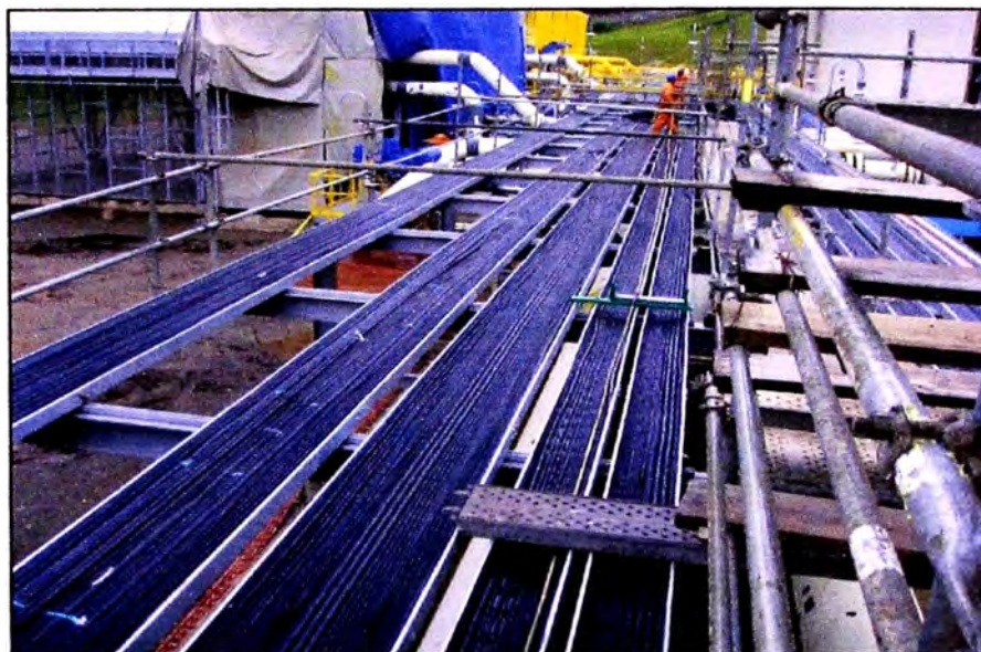
Figura 4.14 - Proceso de tendido de cables de fuerza y comando (Fuente: Foto tomada en Diciembre 2009)
