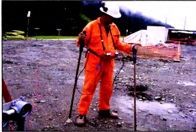
Figura 4.8 – Identificación de fallas de revestimiento de tuberías enterradas (Fuente: Foto tomada en Mayo 2010)
