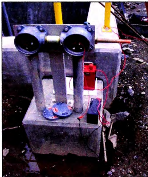
Figura 4.7 – Inyección de corriente DC a las tuberías (Fuente: Foto tomada en Mayo 2010)
