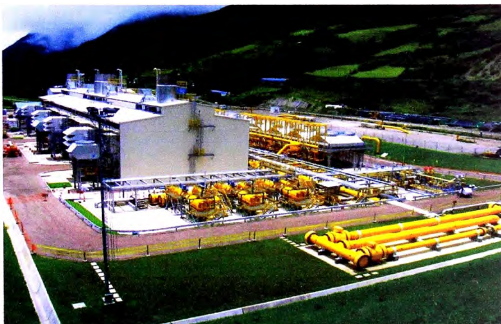
Figura 2.1: Planta Compresora de Gas Natural - Chiquintirca
