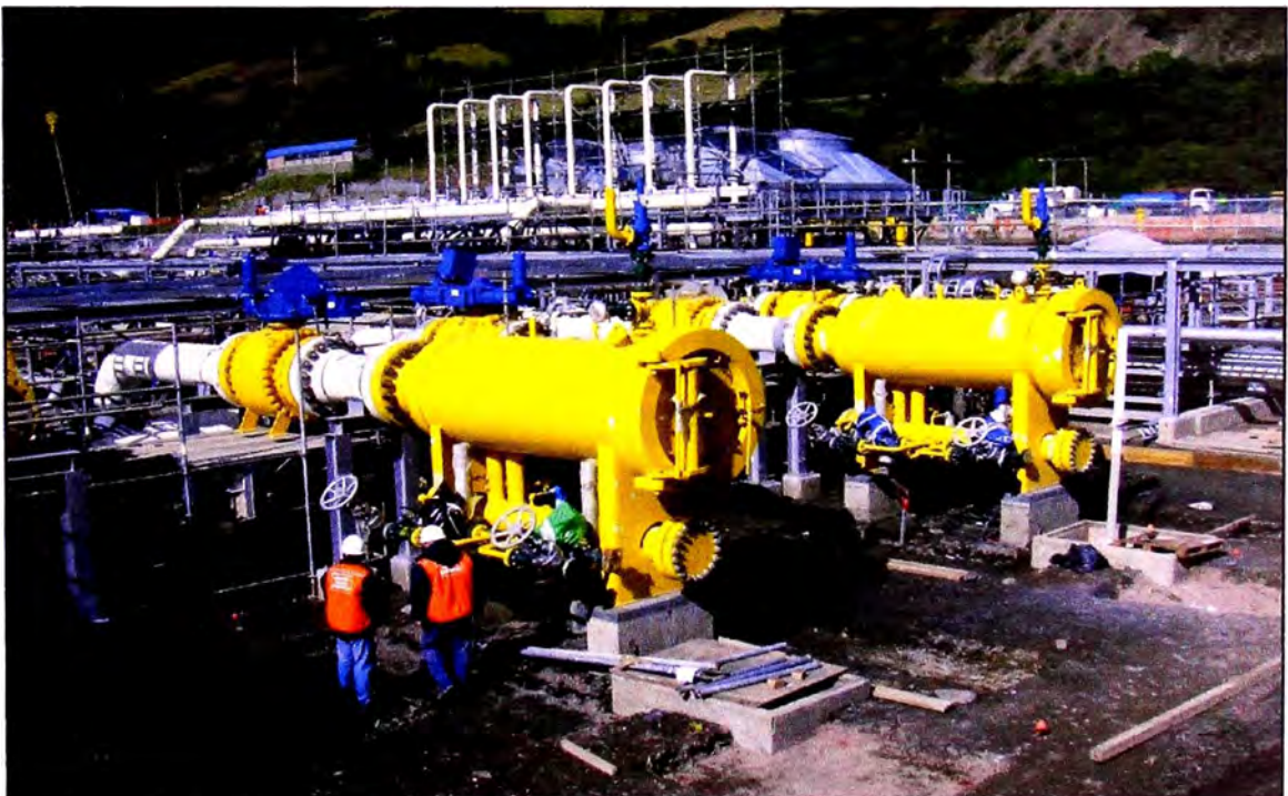
Figura 2.4 – Filtro Separador F-3101A y F-3101B (Fuente: Foto tomada en Noviembre de 2009)
