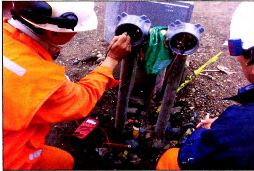
Figura 4.6 – Medición de Potencial de ánodo (Fuente: Foto tomada en Mayo 2010)
