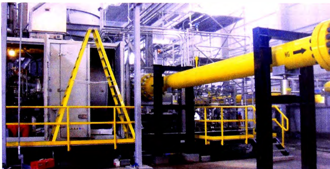
Figura 2.8 – Vista de Turbocompresor A y tubería de descarga (Fuente: Foto tomada Junio 2010)
