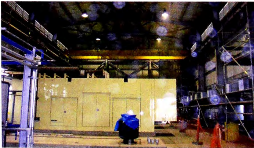
Figura 2.12 – Motogenerador Eléctrico Waukesha isonorizado (Fuente: Foto tomada Enero 2010)
